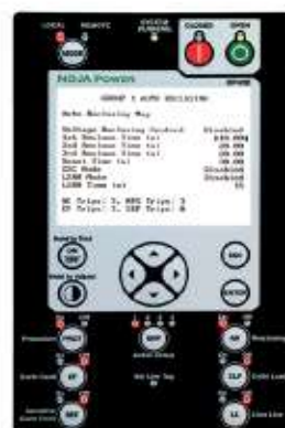
PAINEL DE CONTROLE LOCAL
