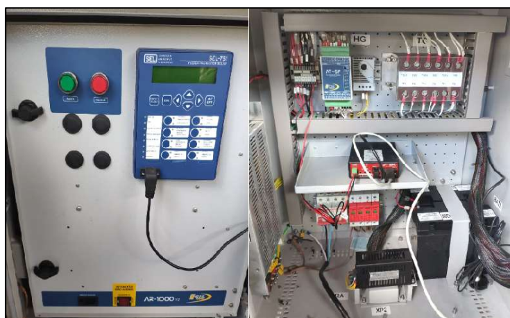
Figura 14 - Caixa de comando e relé tele controlado de religador.
