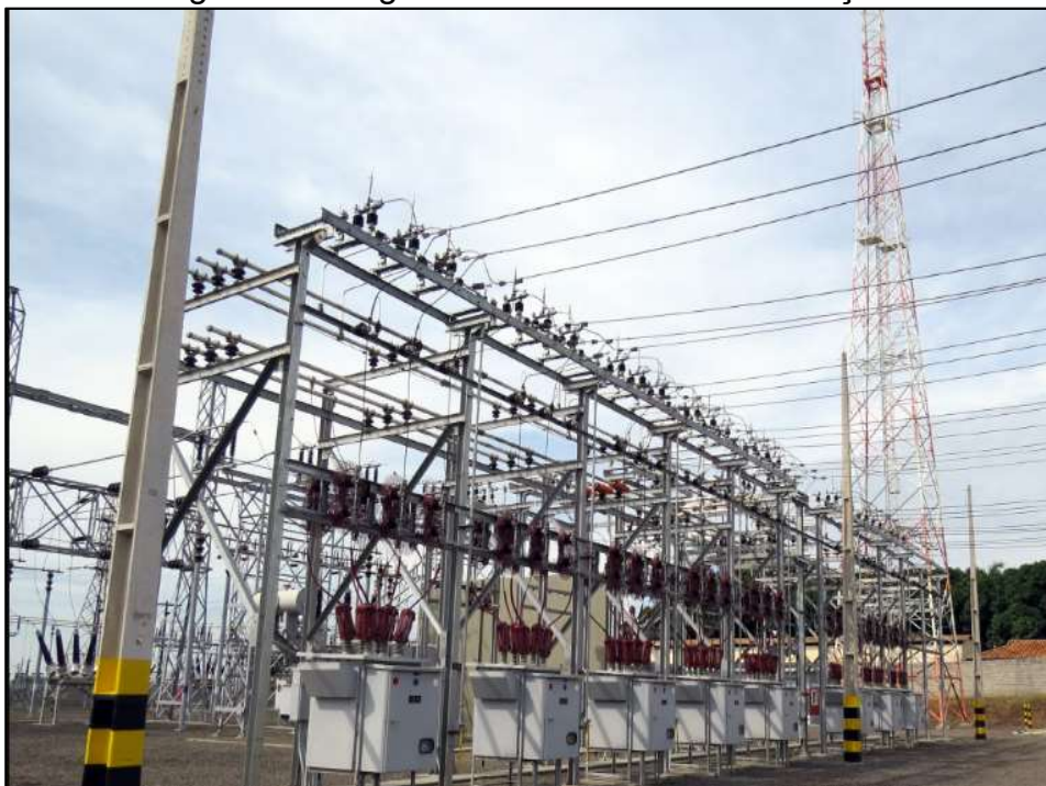
Figura 4– Religadores de saída da Subestação.
