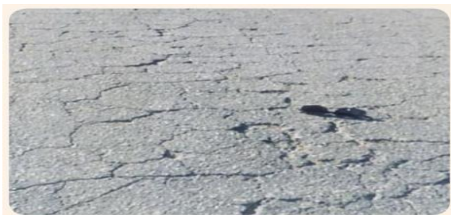
Figura 9: Trinca por fadiga resultantes de tensões repetidas
