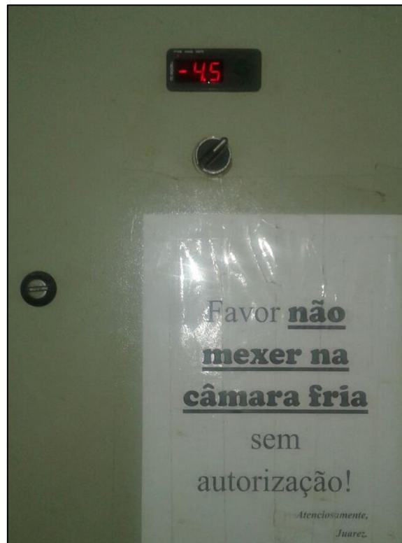
Figura 7 - Quadro de comando da câmara frigorífica fechado
