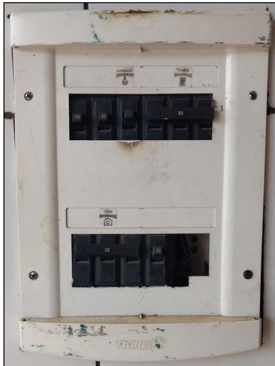
Figura 5 - Quadro geral de distribuição atual
