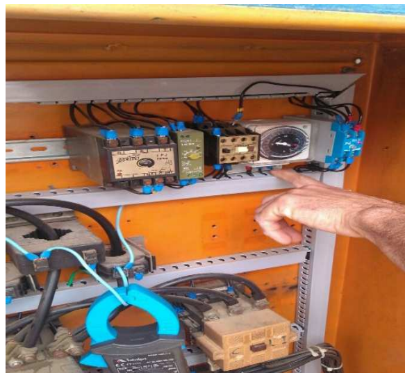
Figura 9 – Quadro de comando funcionando com temporizador
