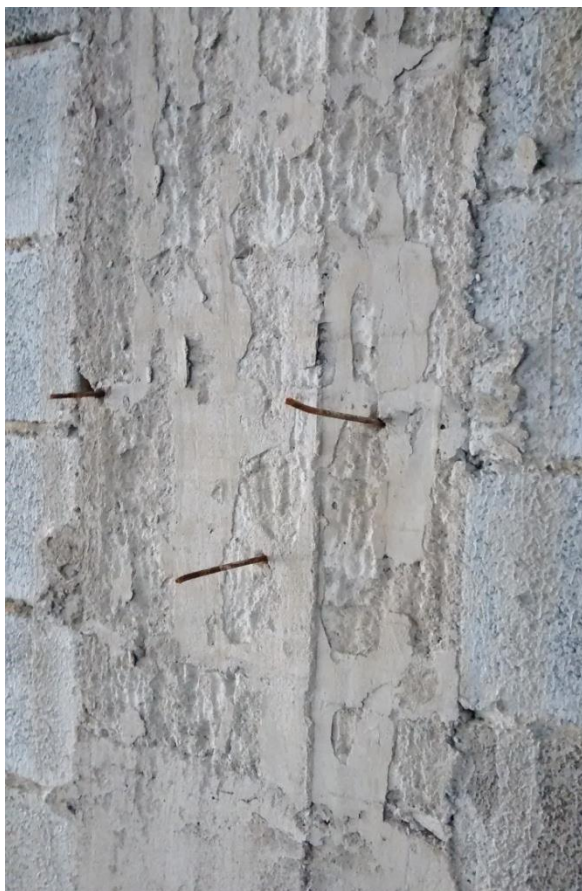
Figura 4: Pilar com possibilidade de hidratação insuficiente das formas
