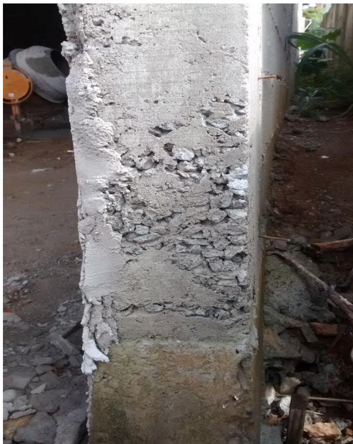
Figura 3: Segregação dos agregados da amassada de concreto
