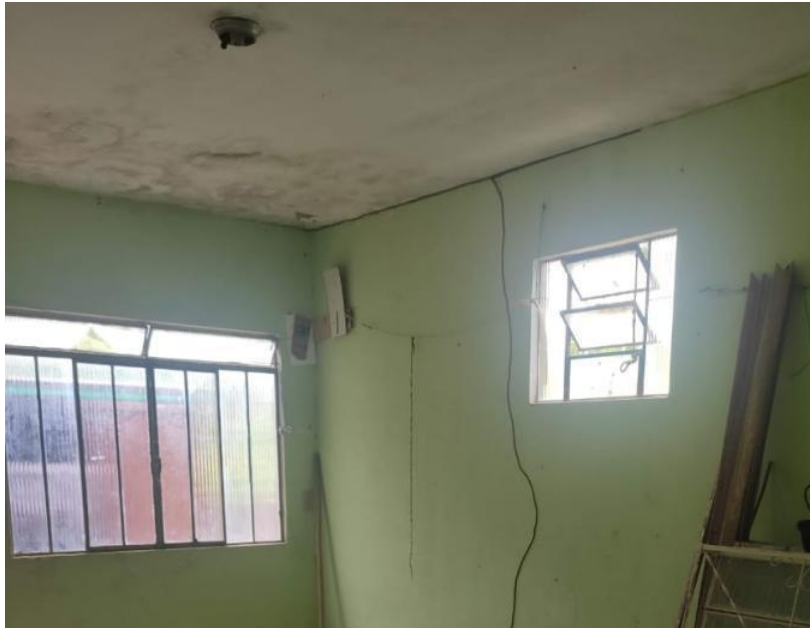
Imagem 11: Imagem evidenciando o mofo no teto
