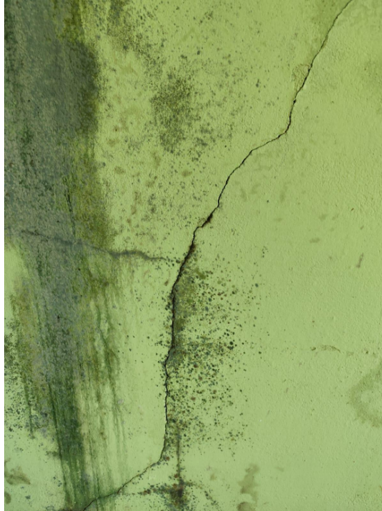
Imagem 10: imagem evidenciando rachaduras
