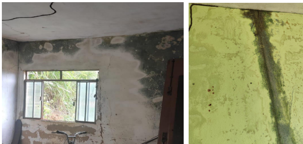
Imagem 12: Imagem evidenciando o mofo nas paredes
