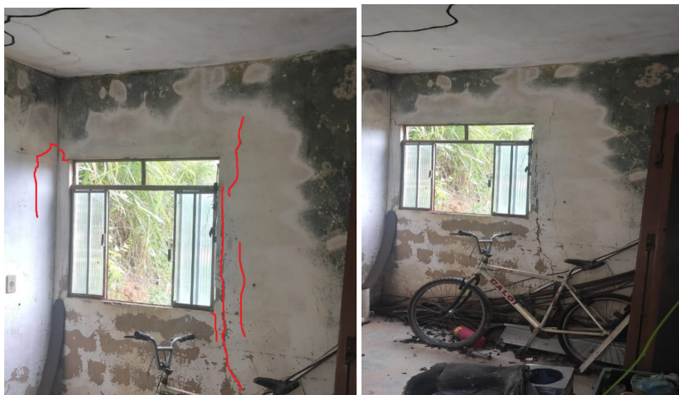
Imagem 09: imagem a de vermelho mostra as atuais rachaduras, na imagem b mostra a imagem sem a indicação das rachaduras
