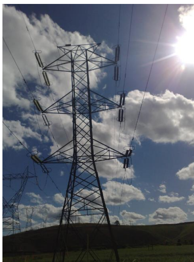
Figura 04: Linha de Transmissão
