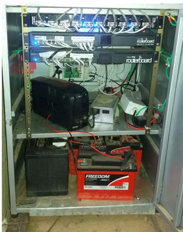
Figura 16: Armário de distribuição da rede de internet da empresa Signet do bairro Santo Antônio
