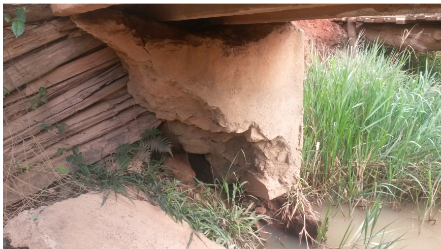
Figura 14: Degradação do Concreto (Autoria Própria)
