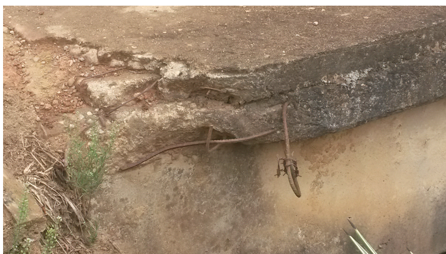
Figura 16: Exposição da Armadura do Tabuleiro (Autoria Própria)
