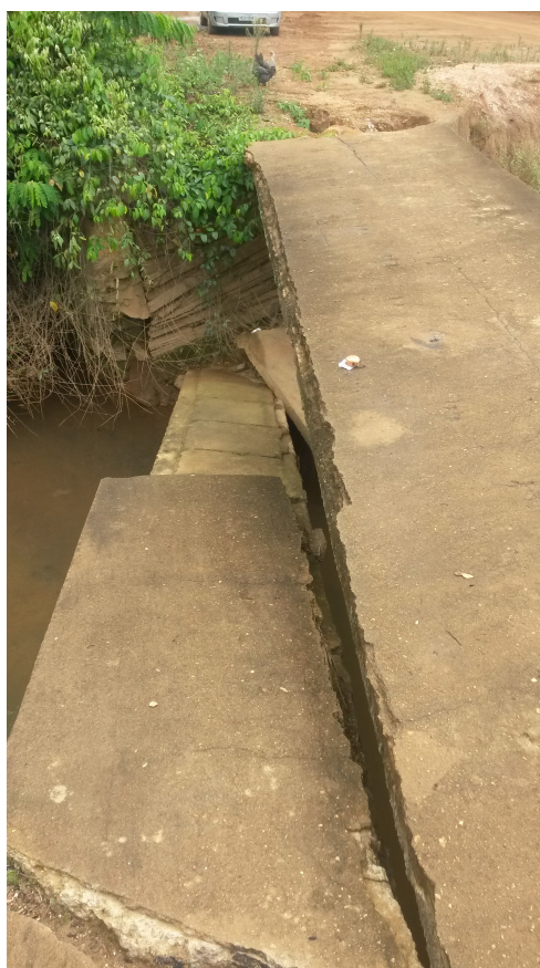
Figura 13: Queda do Tabuleiro(Autoria Própria)
