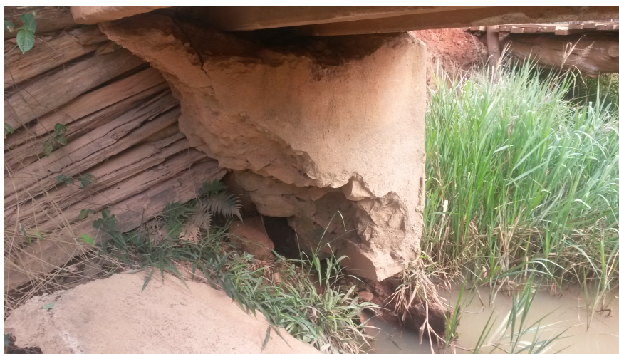
Figura 11: Apoio Danificado (Autoria Própria)
