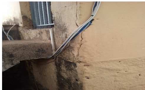
Figura 25: Foto da cobertura com fiação elétrica exposta
