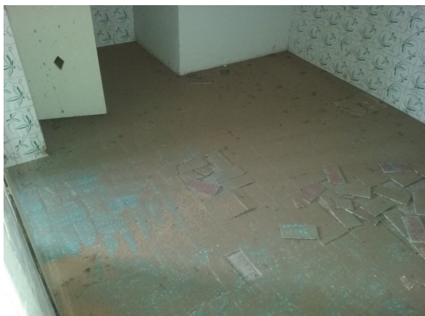
Figura 30: Foto do apartamento 308, deslocamento de revestimento cerâmico.
