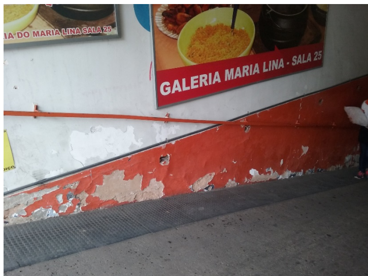
Figura 41: Foto de deslocamento do revestimento na rampa de acesso a garagem.
