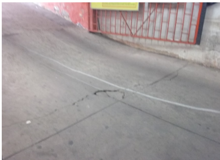
Figura 49: Foto de fissura no piso da rampa de acesso a garagem.
