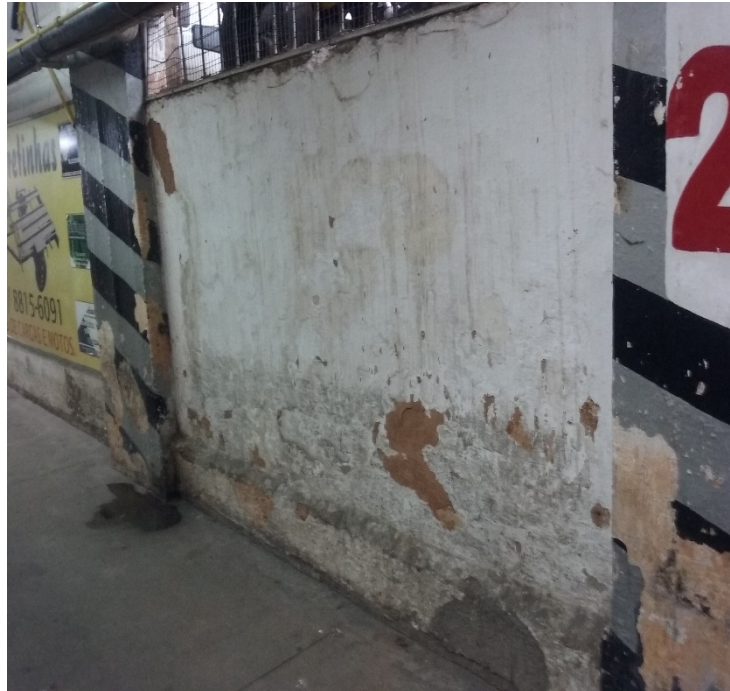
Figura 40: Foto de deslocamento do revestimento na garagem.
