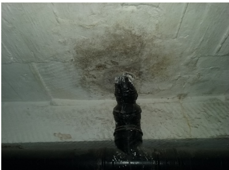
Figura 44: Foto de vazamento ao redor de uma tubulação localizado na garagem
