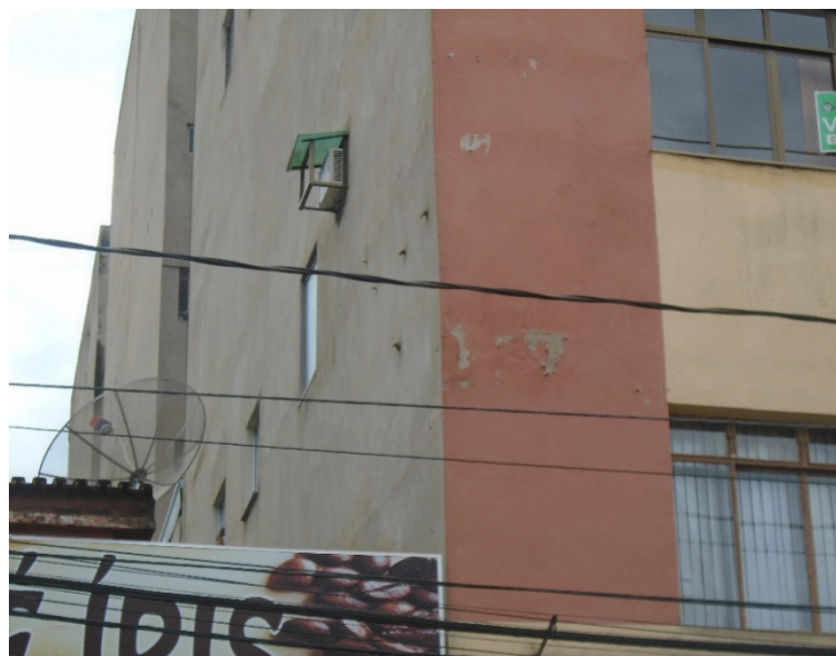
Figura 51: Foto de revestimento da pintura solto na fachada.
