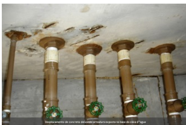
Figura 4: Infiltração na base do reservatório com degradação do concreto
