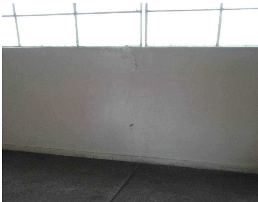
Figura 34: Foto de fissura em alvenaria abaixo das janelas dos corredores.
