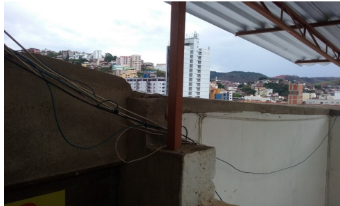
Figura 24: Foto do Hall de circulação da cobertura com fiação elétrica exposta
