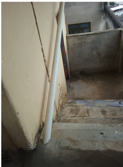
Figura 6: Escada sem corrimão no acesso à cobertura do Edifício Maria Lina
