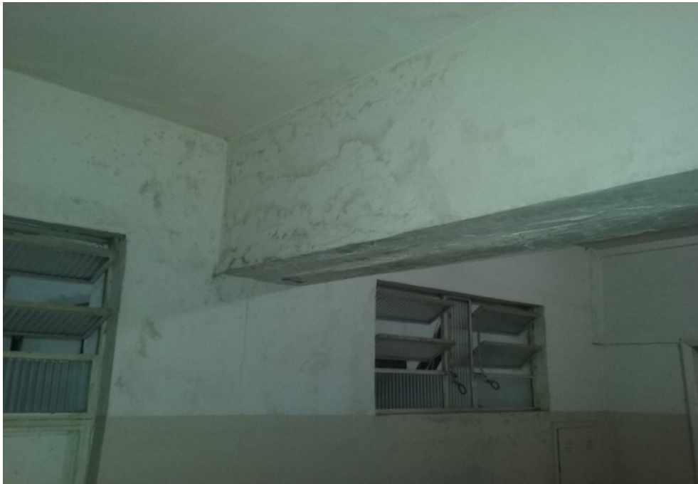
Figura 32: Foto de bolor na viga nos corredores internos do edifício
