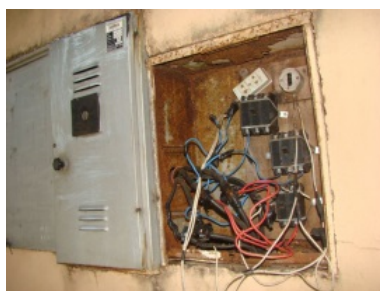
Figura 8: Quadro de distribuição fora dos padrões de segurança
