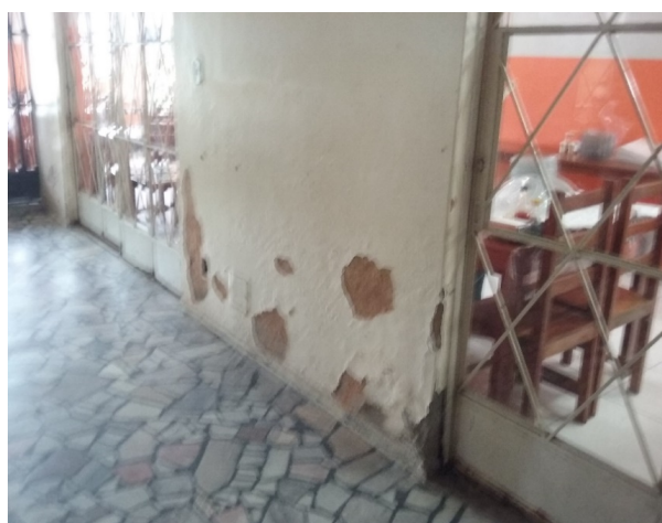
Figura 39: Foto de deslocamento do revestimento
