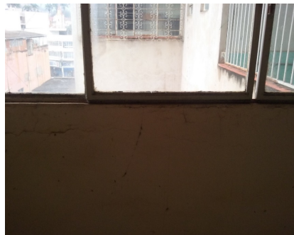
Figura 29: Foto do apartamento 308, deslocamento de revestimento em baixo da janela.
