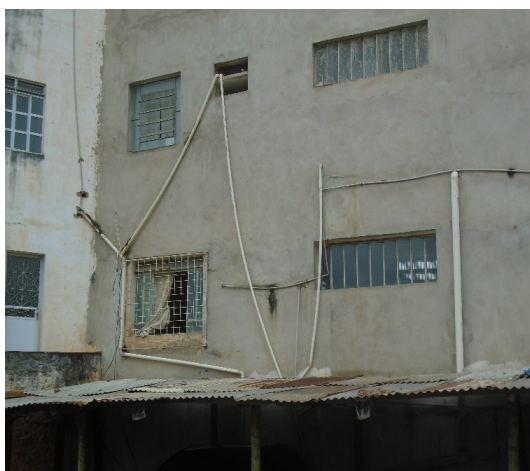
Figura 56: Foto de encanamento exposto na fachada lateral.
