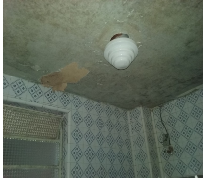
Figura 28: Foto do apartamento 308, deslocamento de revestimento no teto do banheiro social.
