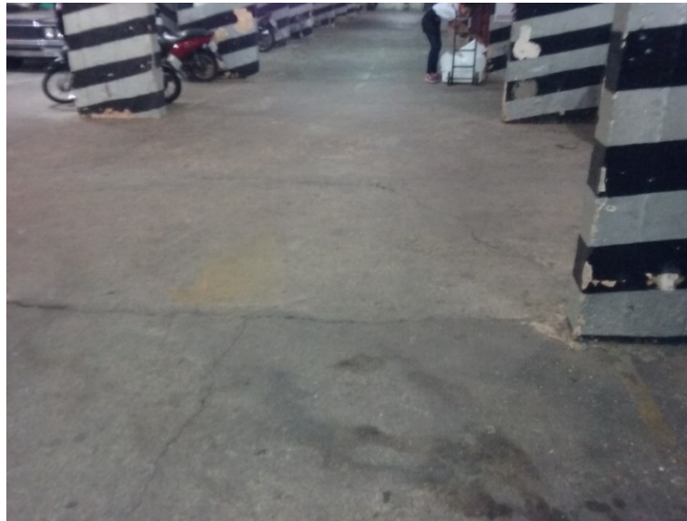
Figura 50: Foto de fissura no piso da garagem.
