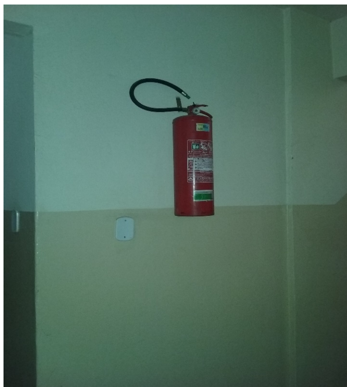
Figura 37: Foto do extintor sem demonstrativo para seu uso
