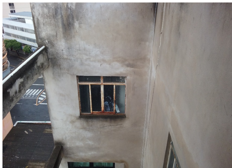
Figura 54: Foto de outra parte da fachada lateral com infiltração.
