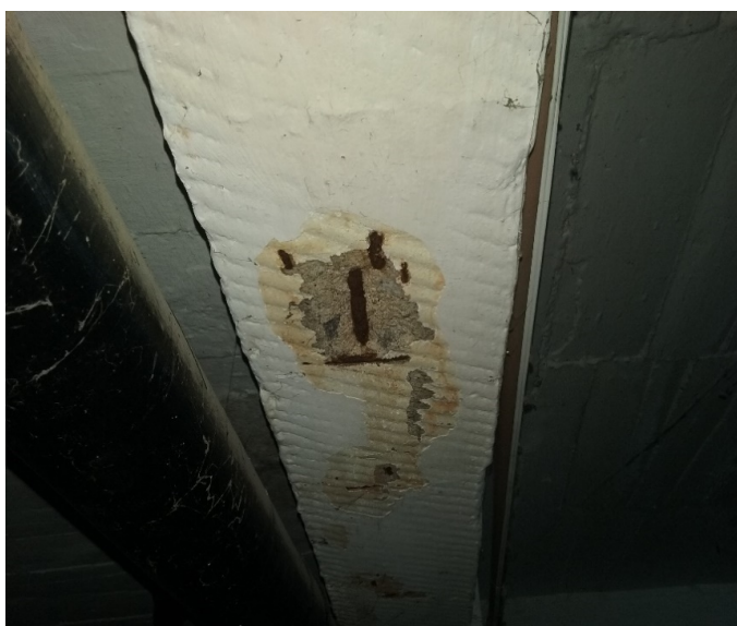
Figura 47: Foto de armadura aparente na viga.
