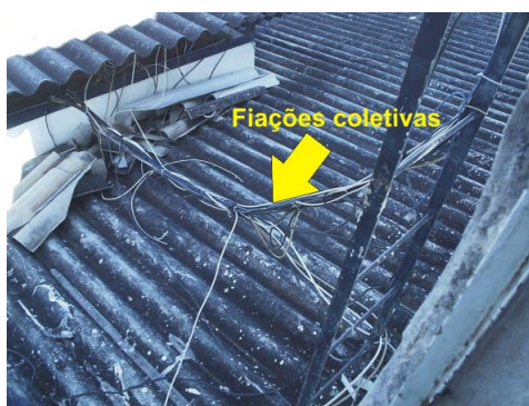
Figura 5: Cabos expostos no telhado
