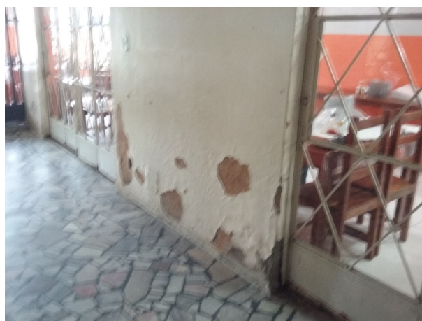
Figura 15: Destacamento do revestimento na galeria do Edifício Maria Lina
