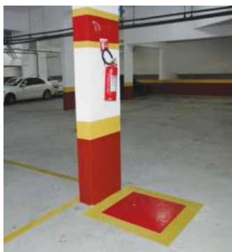
Figura 14: Sinalização correta dos extintores e pilares
