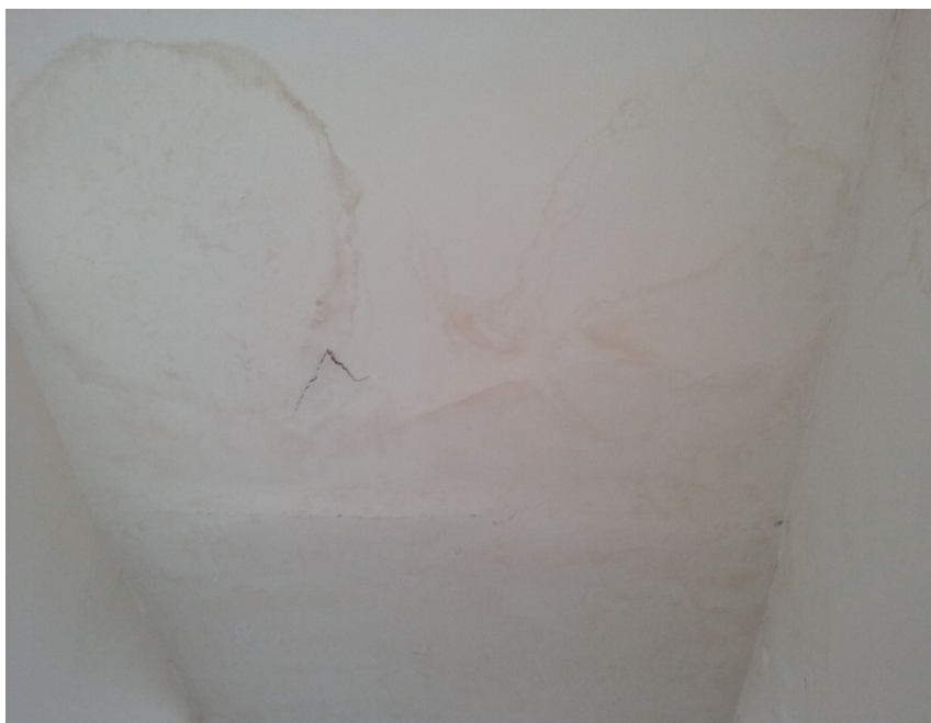
Figura 35: Foto de infiltração de água no teto da escada de acesso aos apartamentos.
