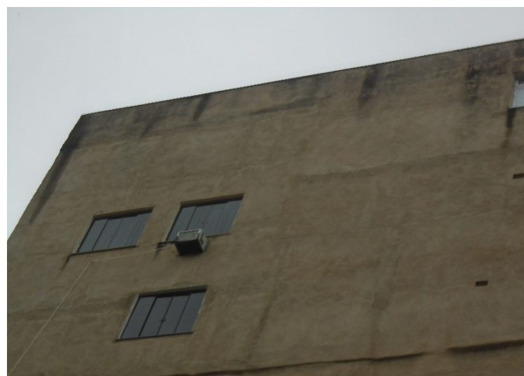
Figura 55: Foto de infiltração na parte superior da fachada lateral.
