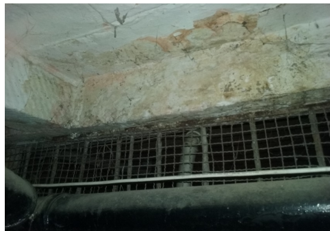
Figura 46: Foto infiltração na viga e laje, localizado na garagem.
