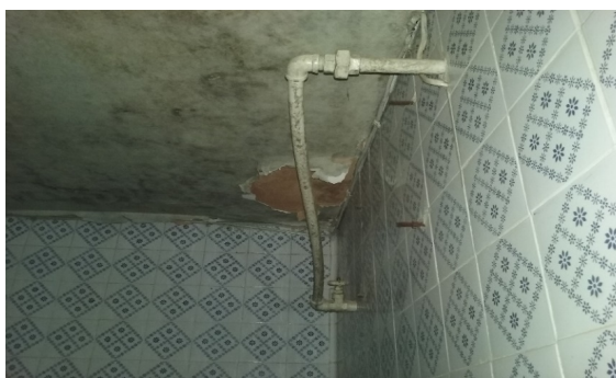
Figura 27: Foto do apartamento 308, deslocamento de revestimento na parede do banheiro.
