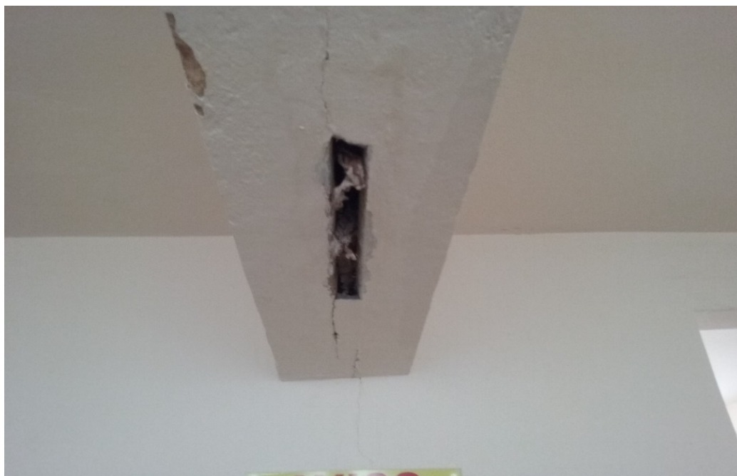
Figura 36: Foto de deslocamento do revestimento da viga.
