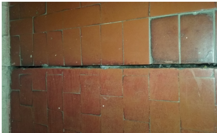
Figura 31: Foto da separação do piso do corredor interno do 3 pavimento
