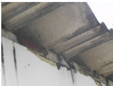
Figura 2: Telhado com infiltrações.
