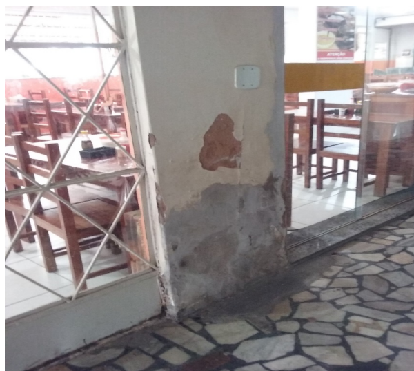
Figura 38: Foto de deslocamento do revestimento com uma manutenção já executada.
