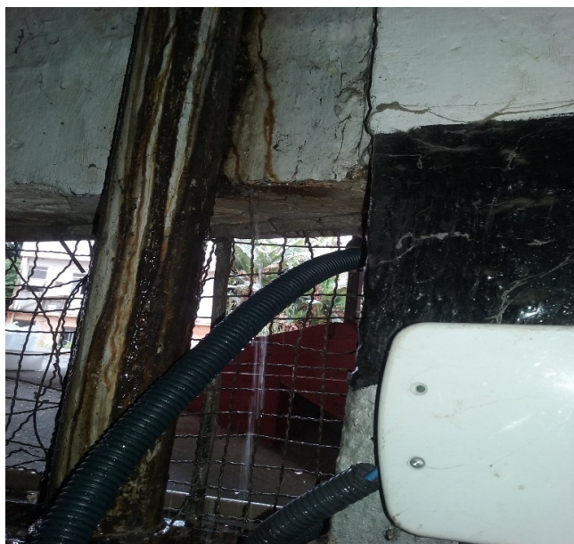
Figura 42: Foto de vazamento na tubulação da garagem.
