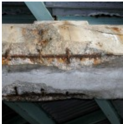
Figura 16: Deslocamento do cobrimento e exposição da armadura
