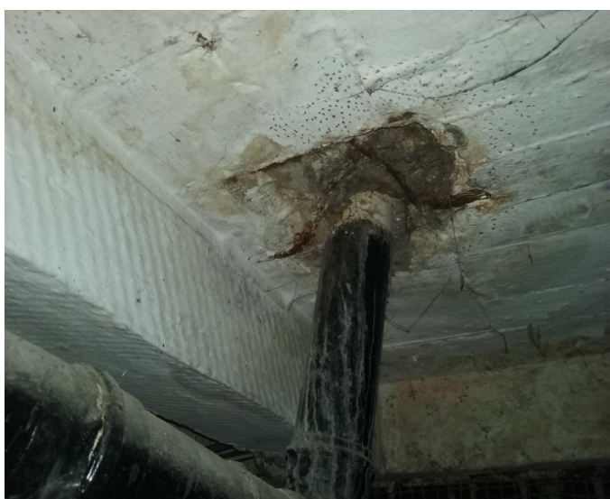
Figura 48: Foto de armadura aparente na laje.
