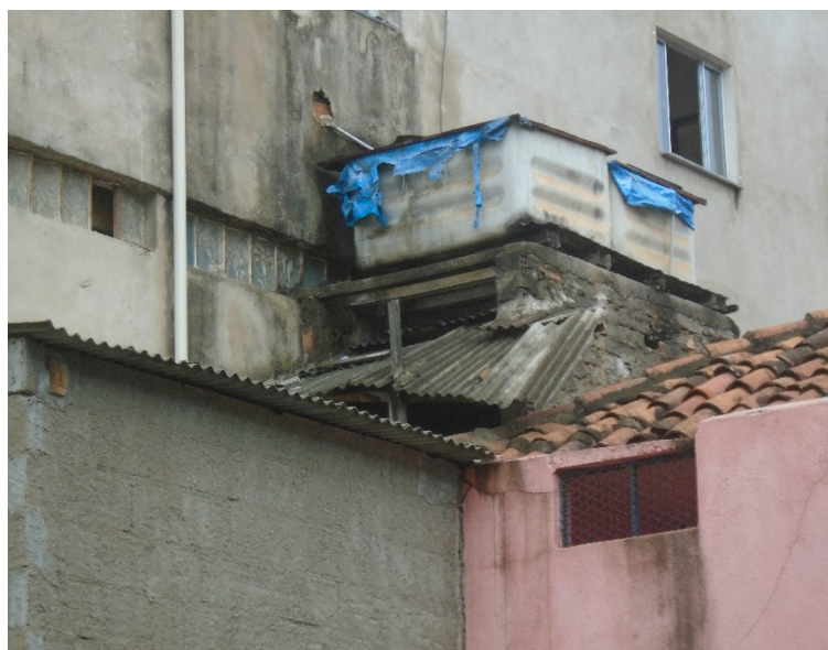
Figura 53: Foto de infiltração da água da chuva na fachada lateral.
