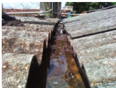
Figura 7: Acumulo de sujeira na calha
