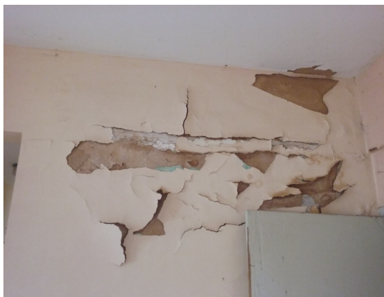
Figura 26: Foto do apartamento 308, deslocamento de revestimento na parede da sala.
