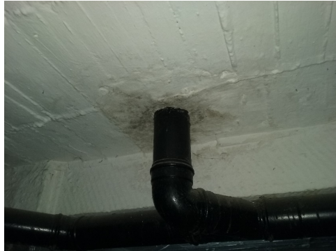
Figura 45: Foto de vazamento ao redor de outra tubulação localizado na garagem.
