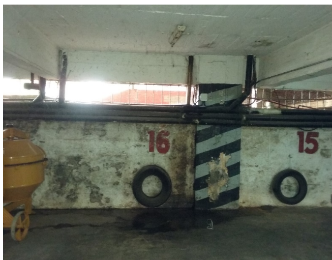
Figura 43: Foto de vazamento na tubulação da garagem.
