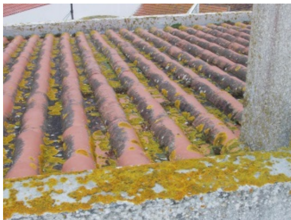
Figura 3: Telhado com fungos.
