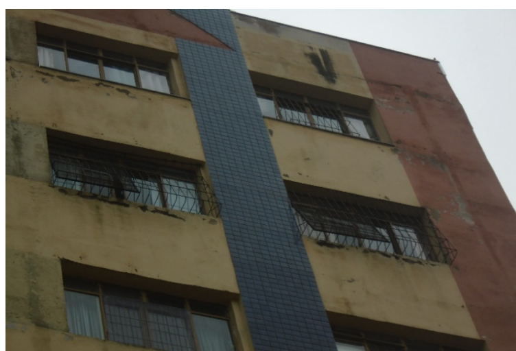
Figura 52: Foto de outro revestimento da pintura solto na fachada.
