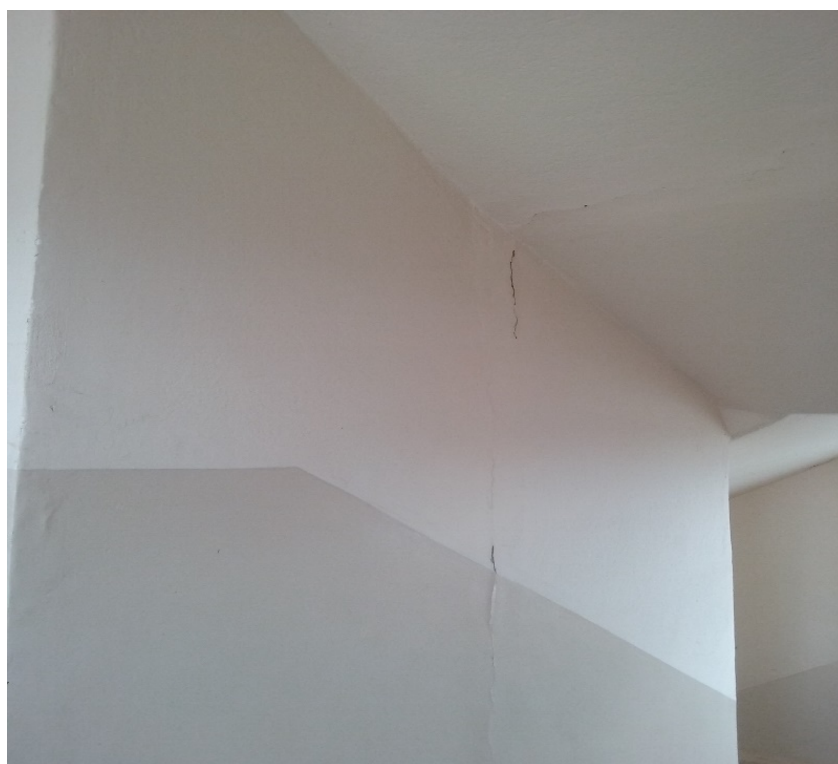
Figura 33: Foto de fissura em alvenaria na escada de acesso para os apartamentos.
