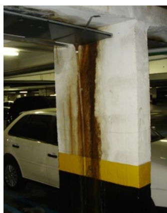
Figura 12: Problema na junta de dilatação sem tratamento causando infiltração e corrosão
