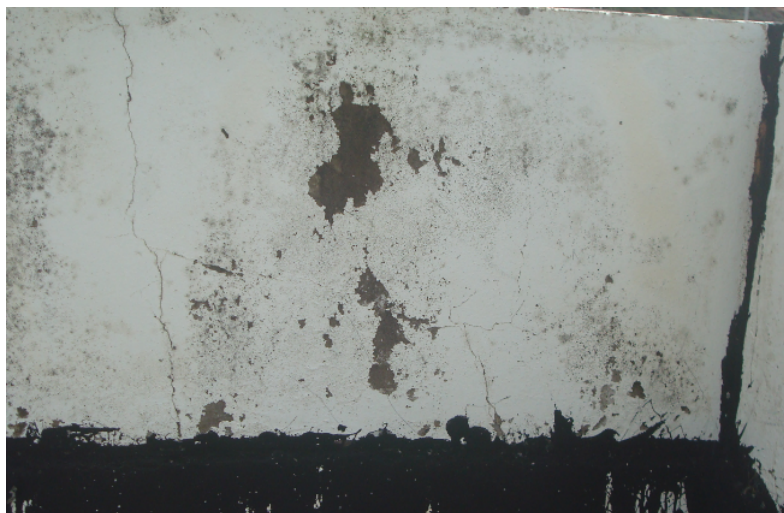
Figura 28: Impermeabilização com desempenho insatisfatório
