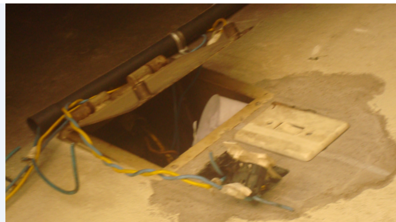
Figura 20: Instalação inadequada dos condutores
