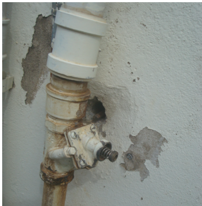
Figura 24: Dispositivo de descarga isolado e inoperante
