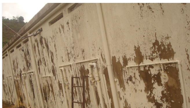
Figura 17: Pintura degradada possivelmente em virtude de infiltração
