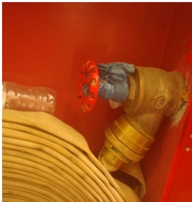
Figura 26: Registro de hidrante apresentando perda de desempenho
