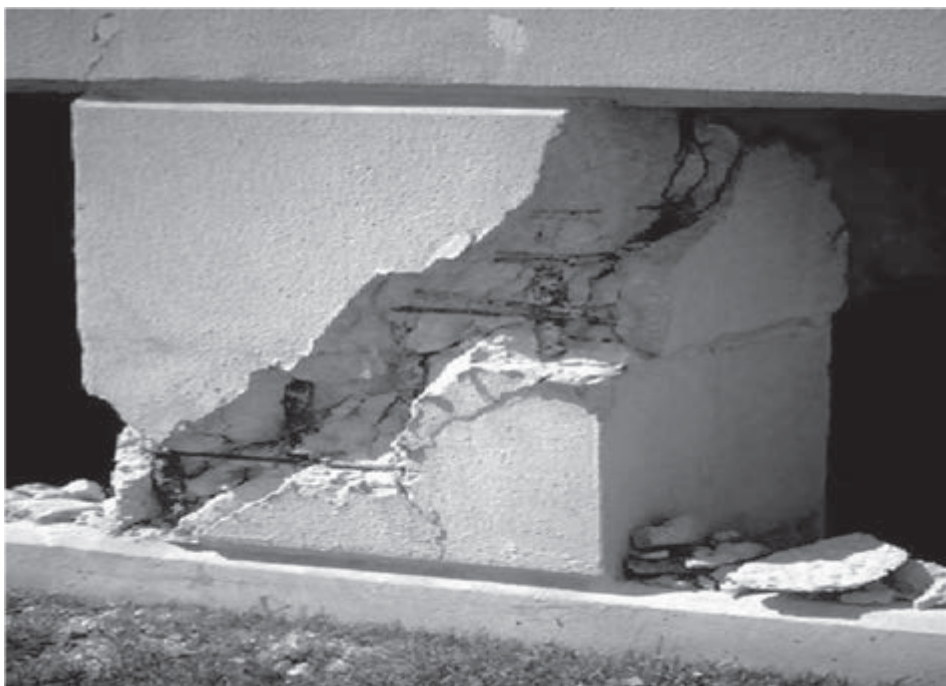
Figura 8: Oxidação do ferro e conseqüente compressão do concreto do pilar Fonte: GRANATO e NEVES, 2009
