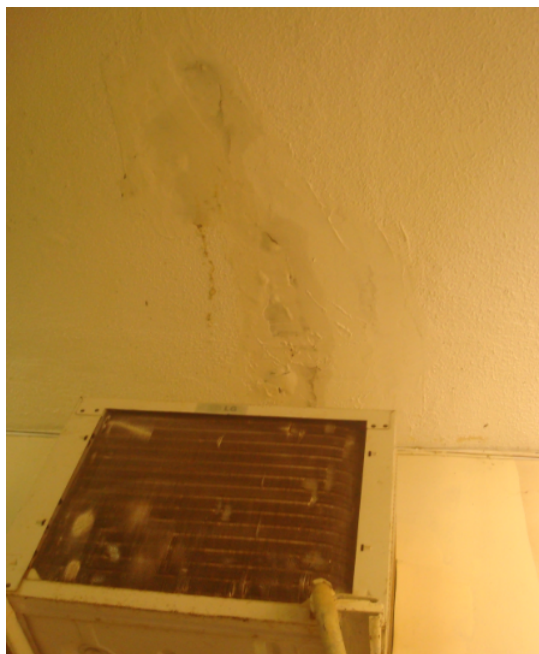
Figura 16: Provável fissura e infiltração na laje
