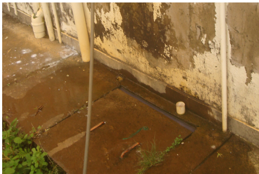
Figura 25: Vazamento na rede de coleta de esgoto
