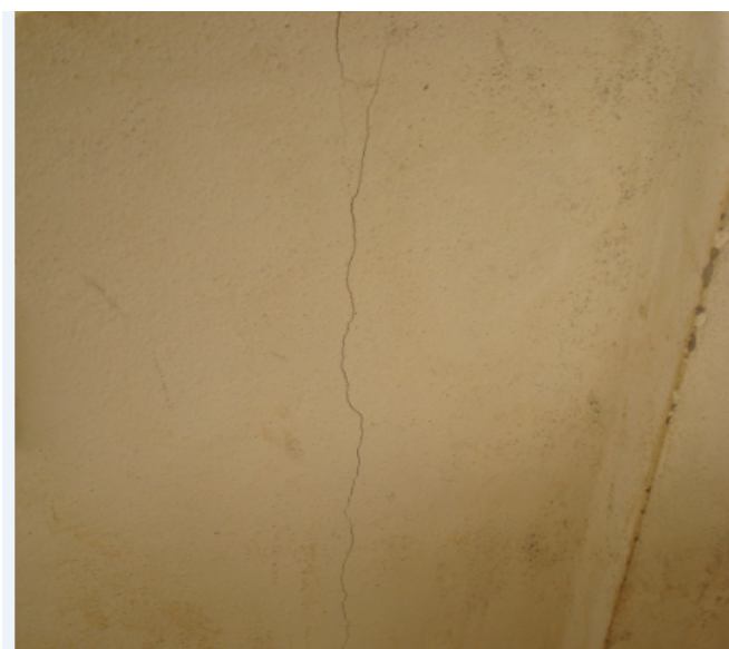
Figura 19: Fissuras aparentes em paredes
