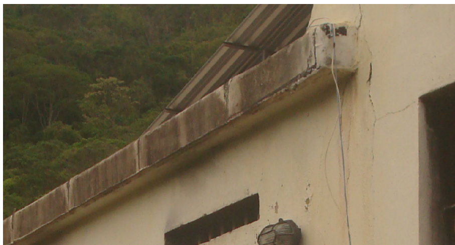
Figura 14: Degradação da laje possivelmente em função do contato com a água.
