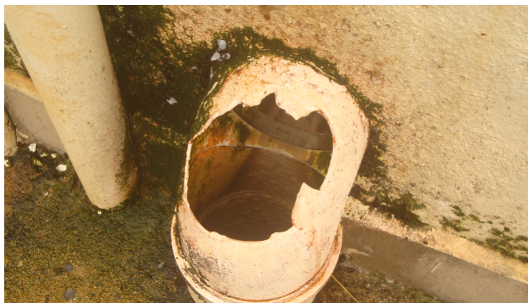
Figura 22: Tubulação danificada com esgoto a céu aberto
