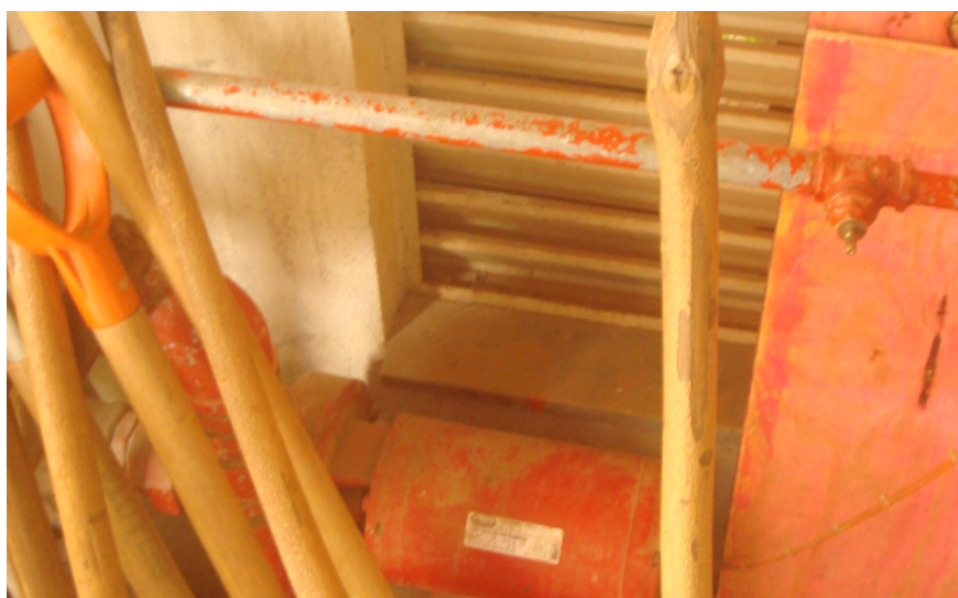
Figura 27: Obstrução no acesso à bomba de incêndio
