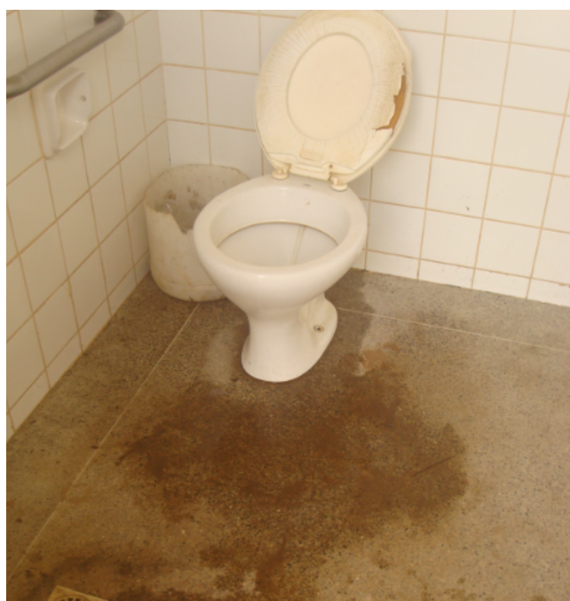
Figura 23: Vazamento no sistema de abastecimento do sanitário
