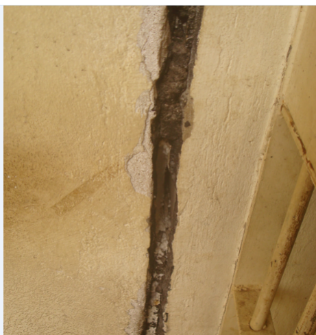
Figura 15: Comprometimento das juntas de dilatação dos pavilhões.
