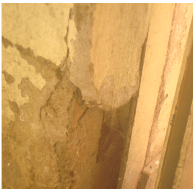
Figura 18: Destruição da alvenaria
