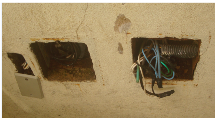
Figura 21: Condutores oferecendo risco de acidentes
