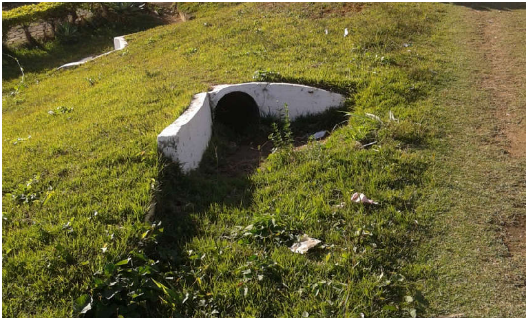
Figura 60 – Vegetação no sistema de escoamento de água
