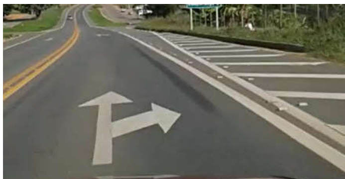
Figura 42 – Sinalização horizontal de direção e canalização
