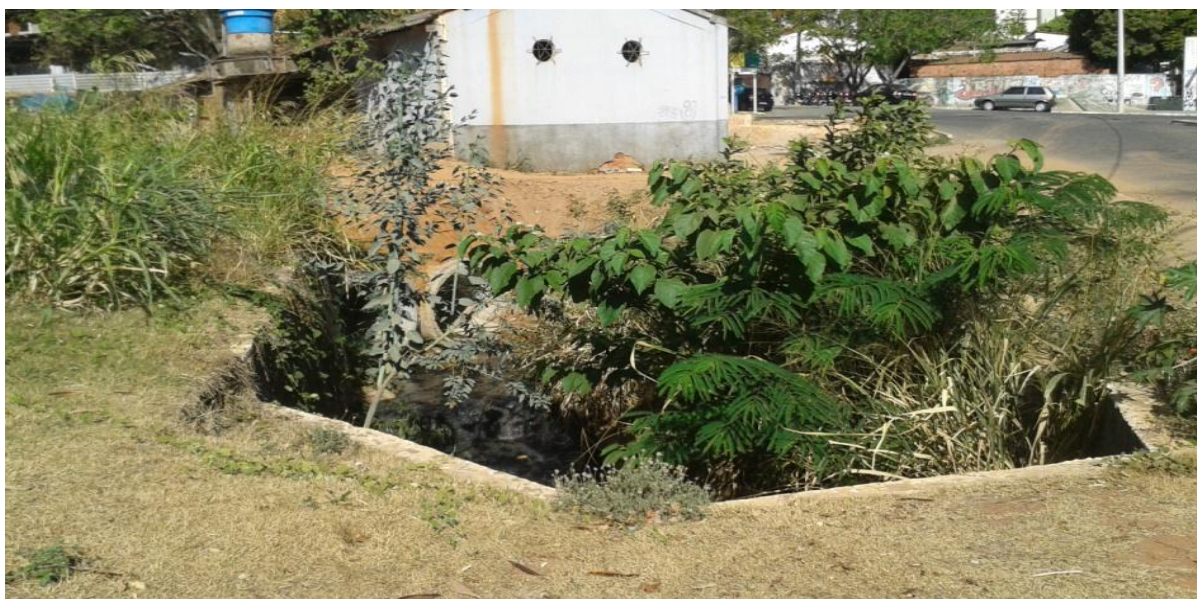
Figura 10 – Local que ocorre lançamento de esgoto a céu aberto próximo ao Fórum da Justiça do Trabalho
