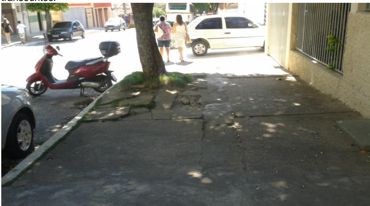
Figura 12 - Uma das calçadas quebradas comprometendo a mobilidade de transeuntes.
