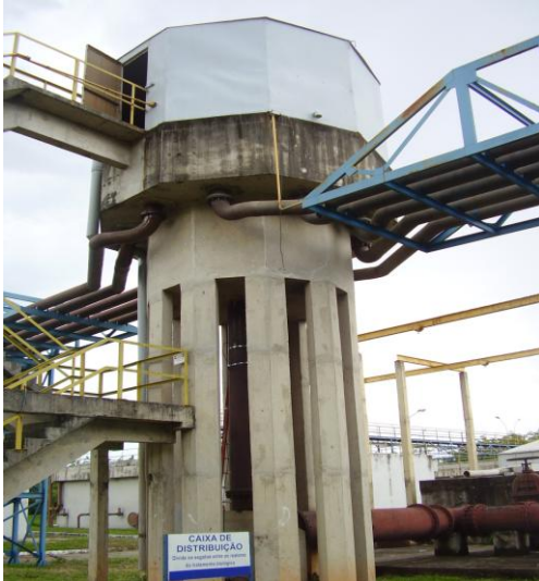
Figura 10: Caixas de distribuição
