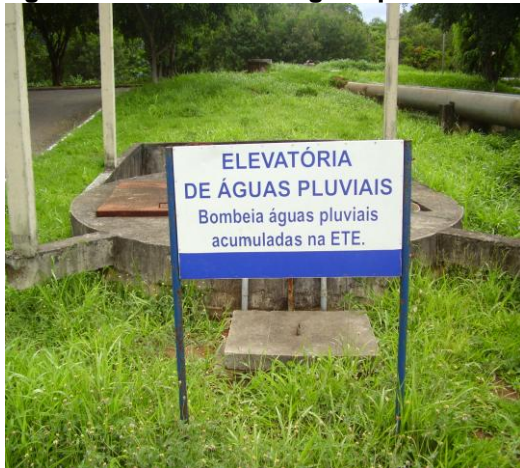
Figura 6: Elevatória de águas pluviais.
