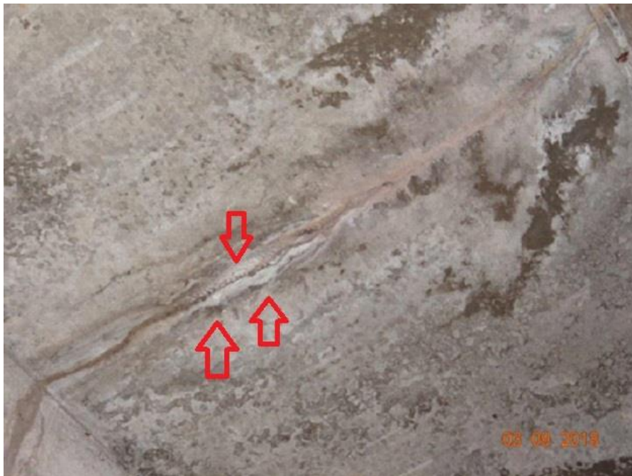
Figura 44 - Eflorescência do concreto
