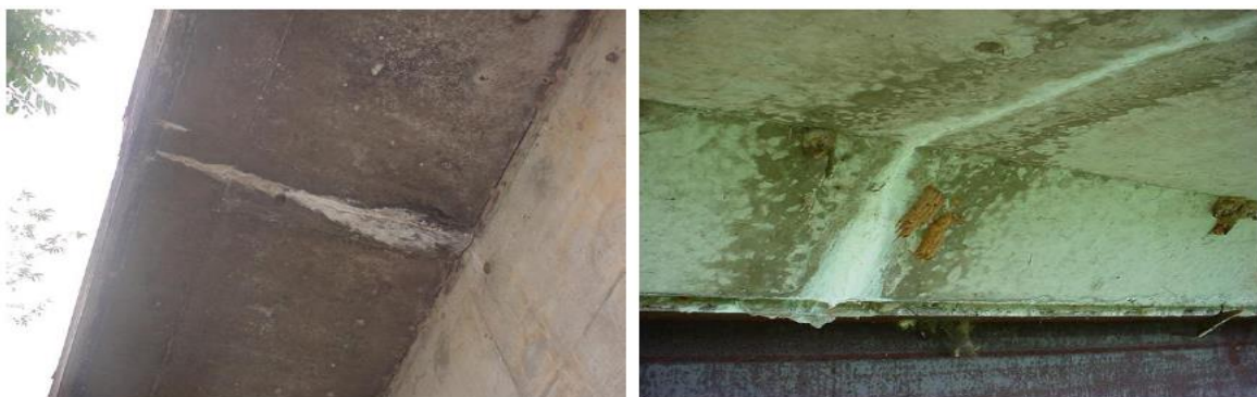
Figura 26 - Eflorescência do concreto
