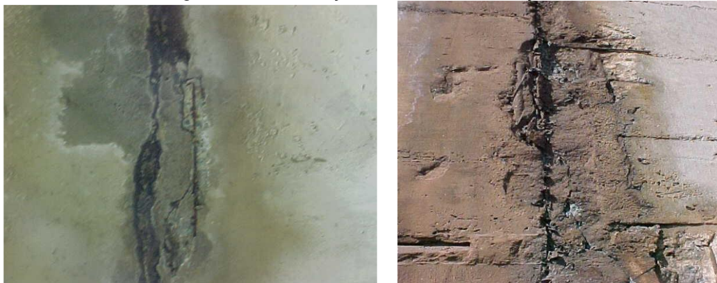
Figura 32 - Deformações na Junta de Dilatação
