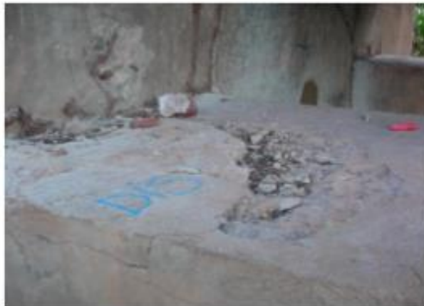
Figura 23 - Disgregação do concreto
