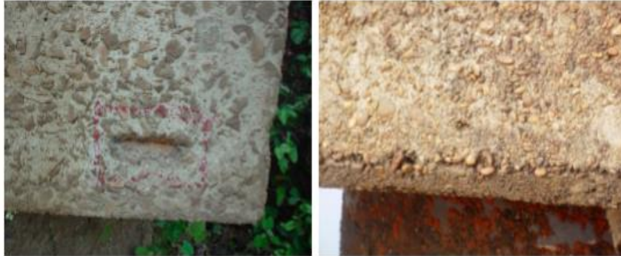
Figura 24 - Erosão do concreto
