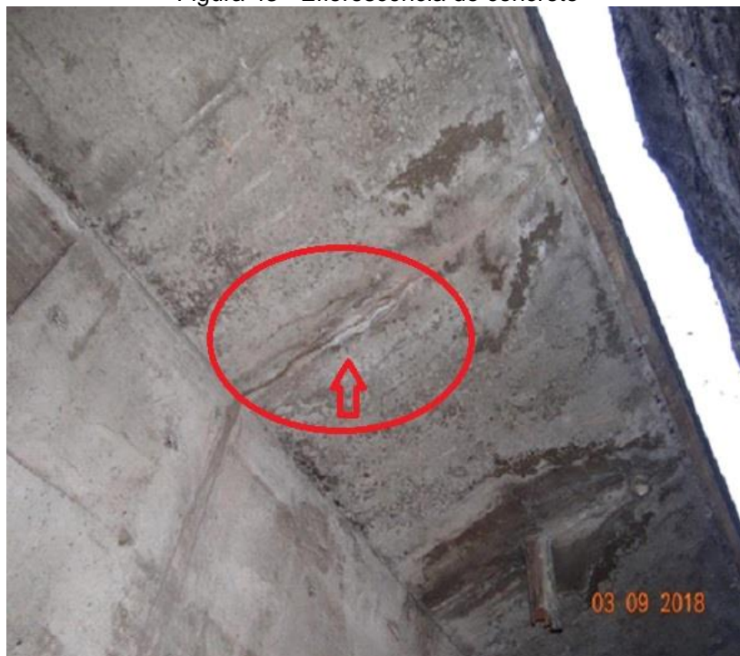
Figura 43 - Eflorescência do concreto
