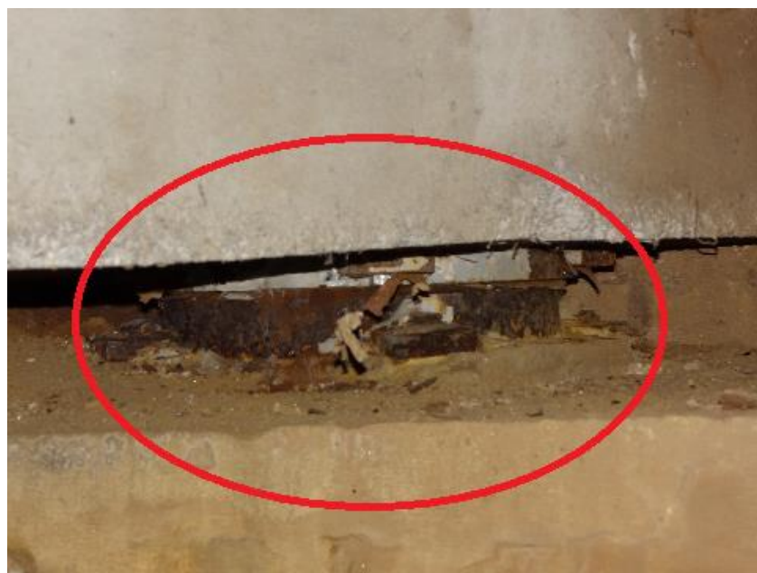
Figura 42 – Deformação e corrosão no aparelho de apoio
