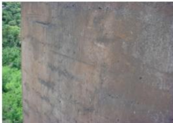
Figura 25 - Cobrimento insuficiente do concreto
