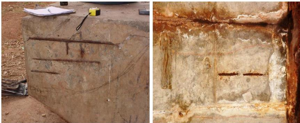
Figura 30 - Corrosão da armadura
