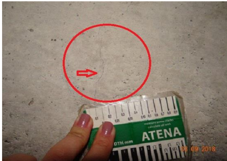
Figura 39 - Fissura encontrada na superestrutura
