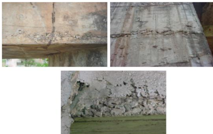
Figura 22 - Segregação do concreto
