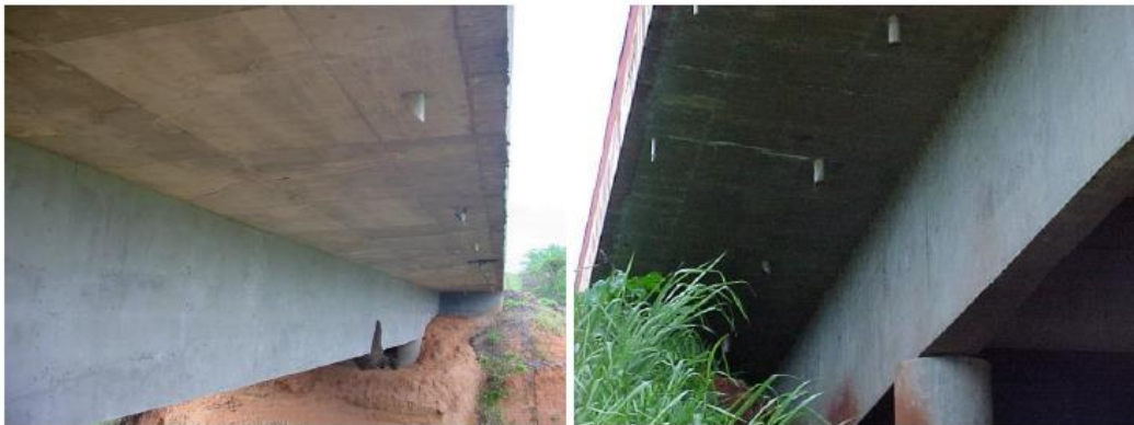
Figura 05 - Pingadeiras no tabuleiro.
