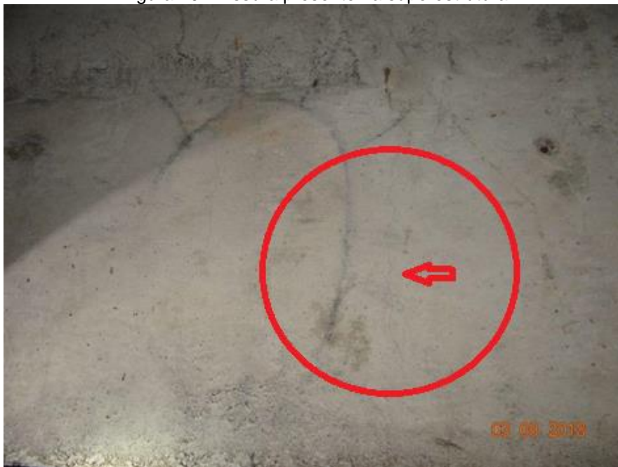
Figura 40 - Fissura presente na superestrutura
