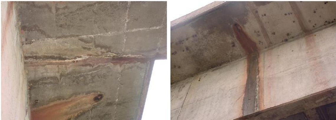
Figura 27 - Umidade e Infiltração
