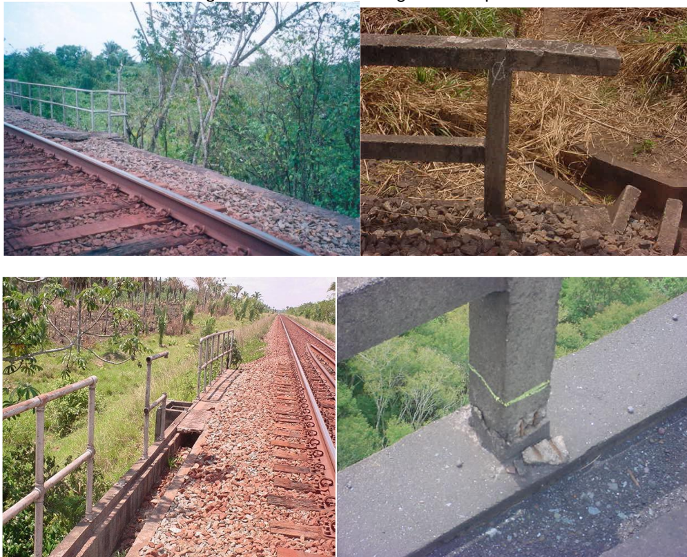
Figura 33 - Corrosão em guarda-corpo
