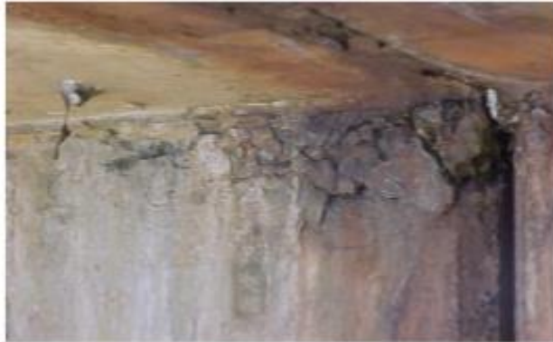
Figura 21 - Desagregação de concreto
