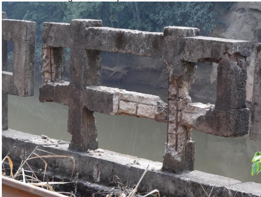
Figura 36 - Desplacamento do concreto
