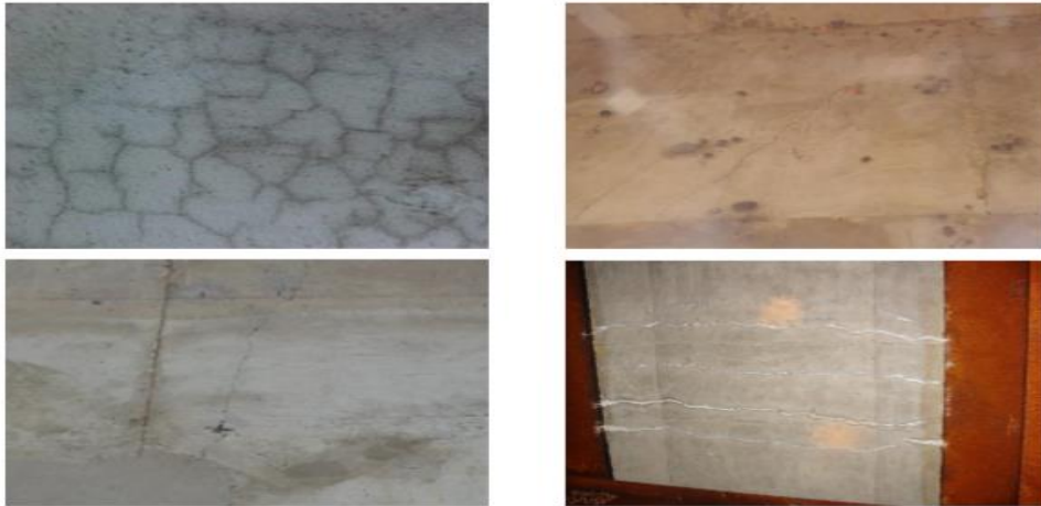
Figura 20 - Gradação das fissuras
