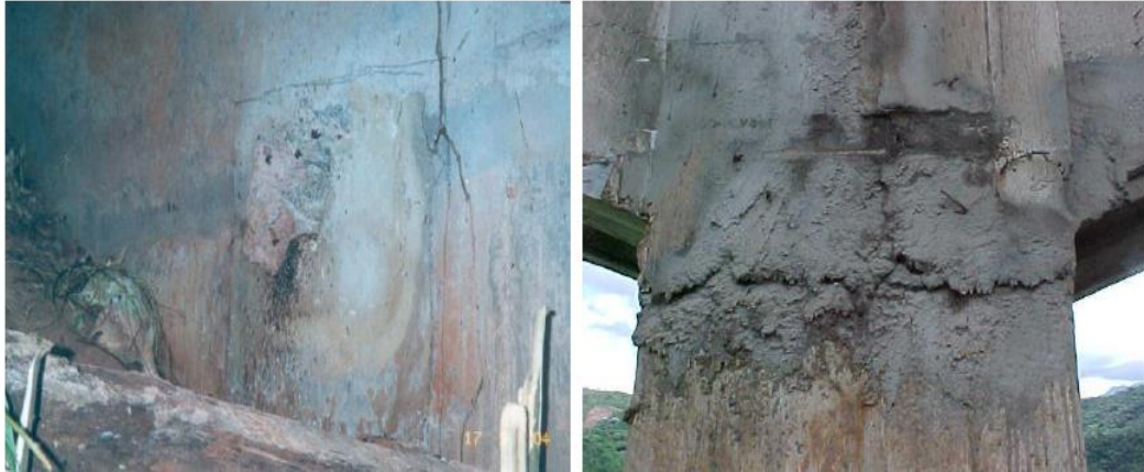
Figura 28 - Falhas em reparos estruturais
