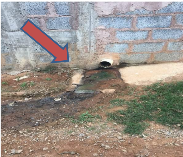
Figura 16: Esgoto a "céu aberto"
