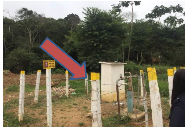
Figura 11: Poço de captação d'água
