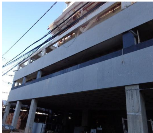
Figura 8: Pilares Sem Revestimento
