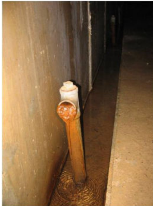
Figura 11 - Ocorrência de colmatação química em drenos.
