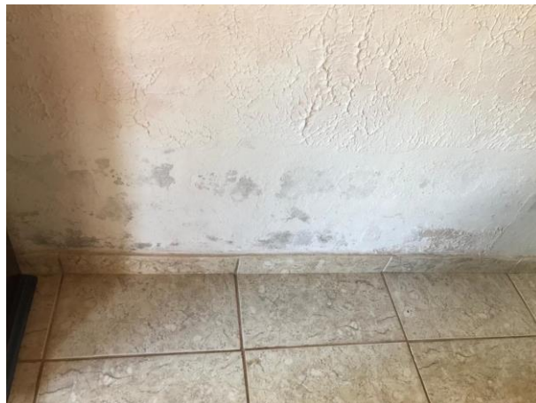
Figura 10 – Parede da sala com infiltração
