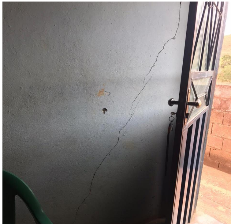
Figura 55 – Trincas na parede da sala
