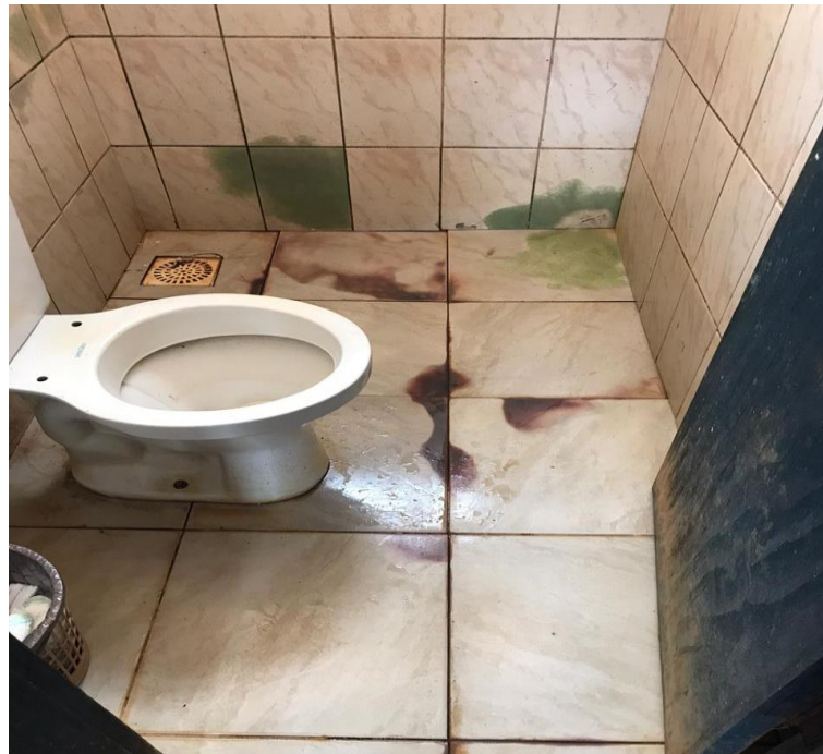
Figura 6 – Infiltração no revestimento e piso do banheiro
