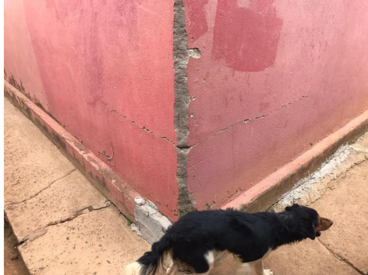
Figura 59 – Trinca na parede externa
