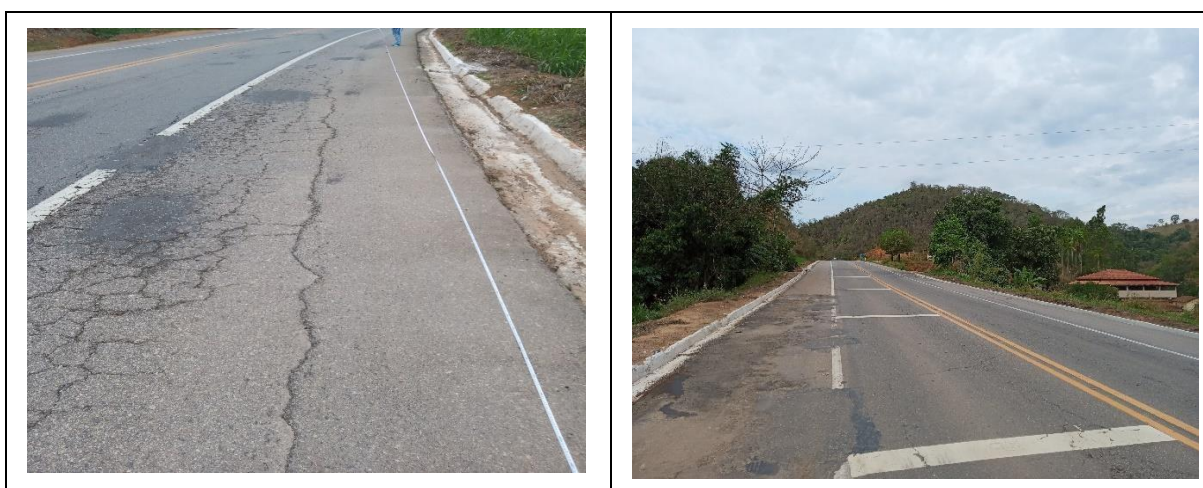
Figura 37 - Trincas longitudinais e interligadas (a) e marcas de reparo, queimaduras e afundamento (b)
