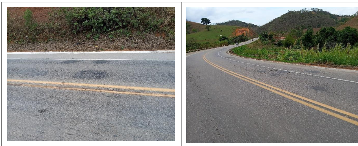
Figura 36 - Marcas de reparo de buracos (a) e trincas interligadas
