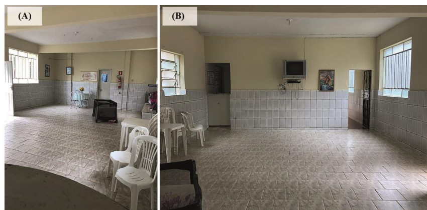
Figura 40 - Falta de cor na sala de convívio
