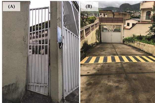
Figura 39 - Falta de cor na entrada da edificação – (A): portão muito estreito e com necessidade de pintura; e (B): rampa de acesso com pintura danificada
