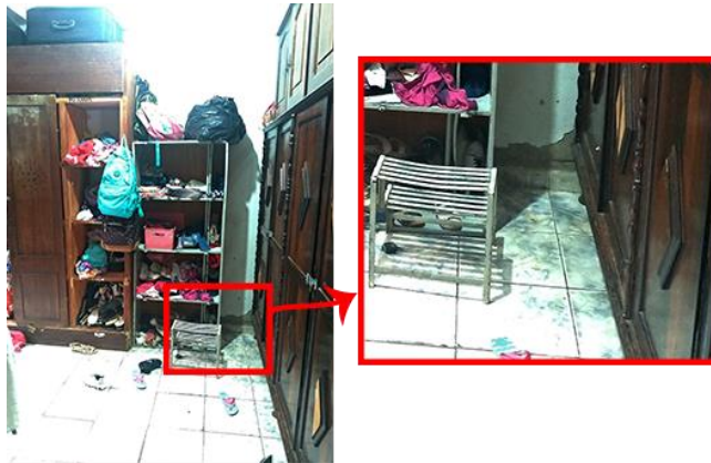
Figura 47 - Desgaste da pintura devido à infiltração entre os armários de roupas
