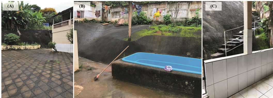
Figura 29 - Piscina - (A): vista de sua localização; (B): tamanho pequeno e estrutura com presença de umidade e bolor; (C): entorno imediato
