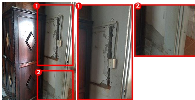
Figura 48 - Desgaste da pintura devido à infiltração e possível tentativa de instalação elétrica, ao lado da porta de entrada
