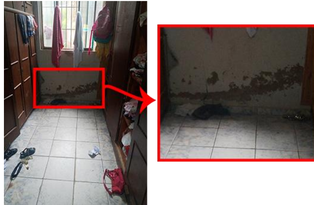
Figura 46 - Desgaste da pintura devido à infiltração debaixo da janela
