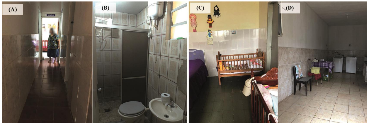
Figura 33 - Baixa iluminação natural do lado da fachada oeste – (A): corredor de acesso aos quartos e banheiros; (B): banheiro social; (C): berçário; e (D): lavanderia
