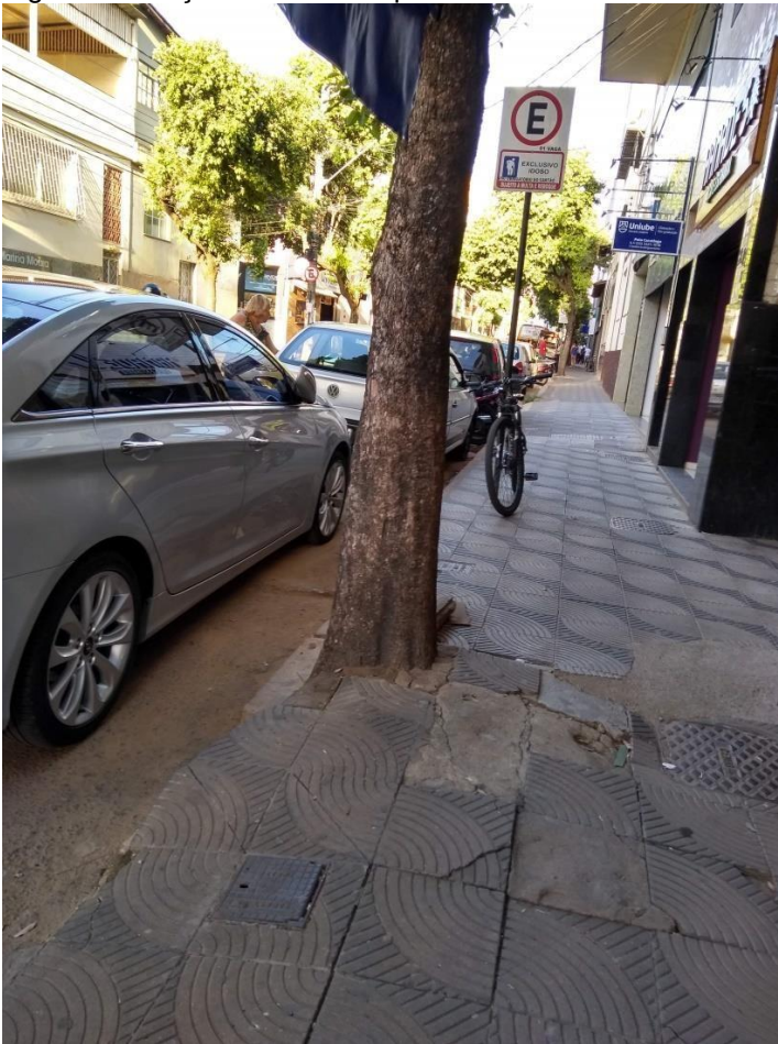
Figura 35: calçada danificada pela raiz da árvore
