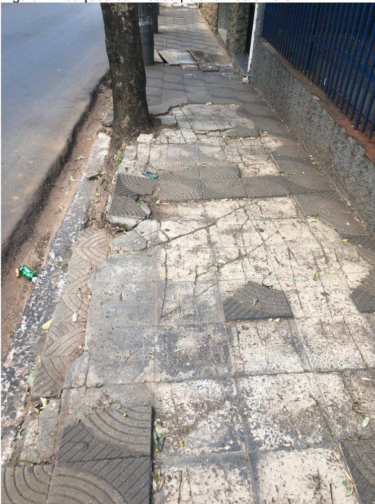
Figura 21: calçada danificada pela raiz da árvore
