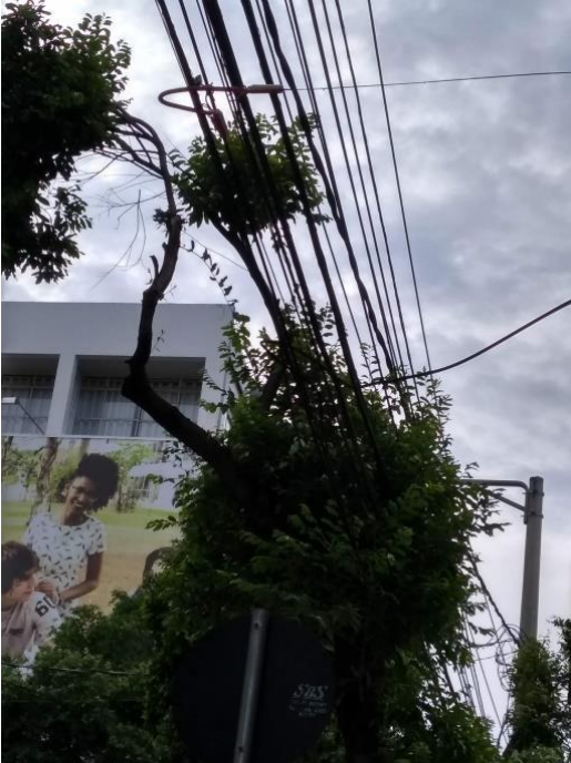
Figura 22: galhos em meio à fiação elétrica
