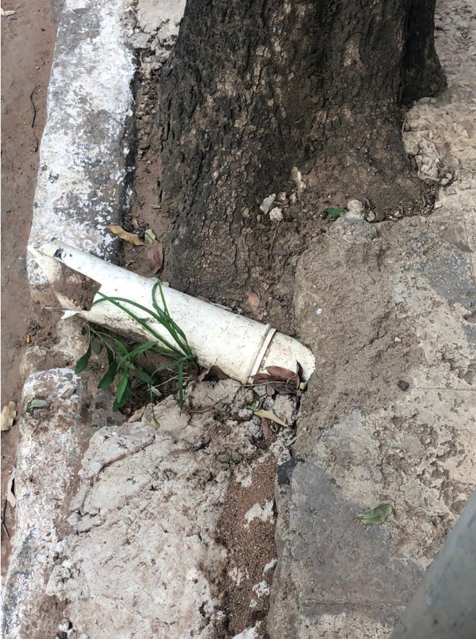
Figura 25: calçada danificada pelo plantio inadequado
