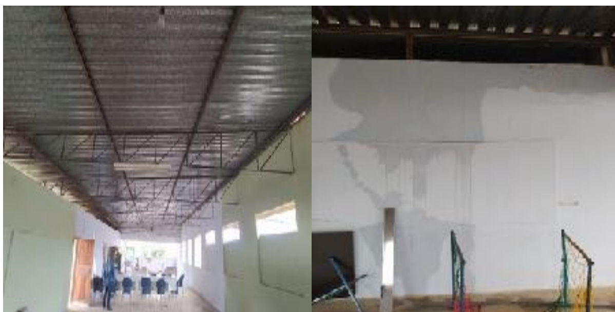
Imagem 26- Telhado e Umidade Causada Pela Chuva
