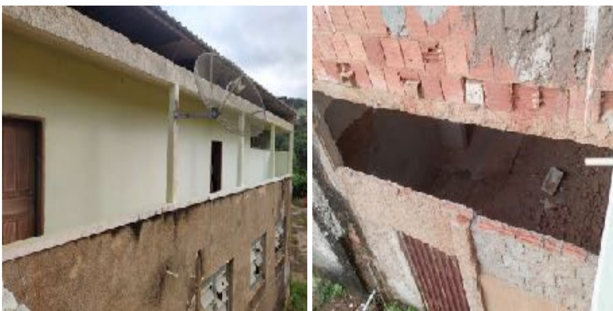
Imagem 29- Mureta do Corredor e Entulhos do Térreo
