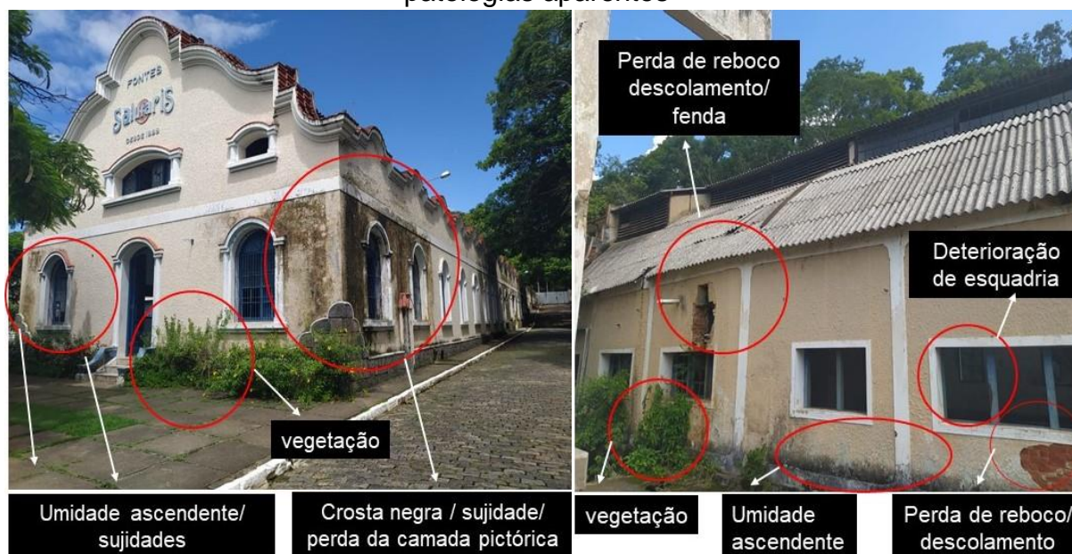
Figura 54: Fotografia das fachadas da antiga fábrica com a indicação de suas patologias aparentes
