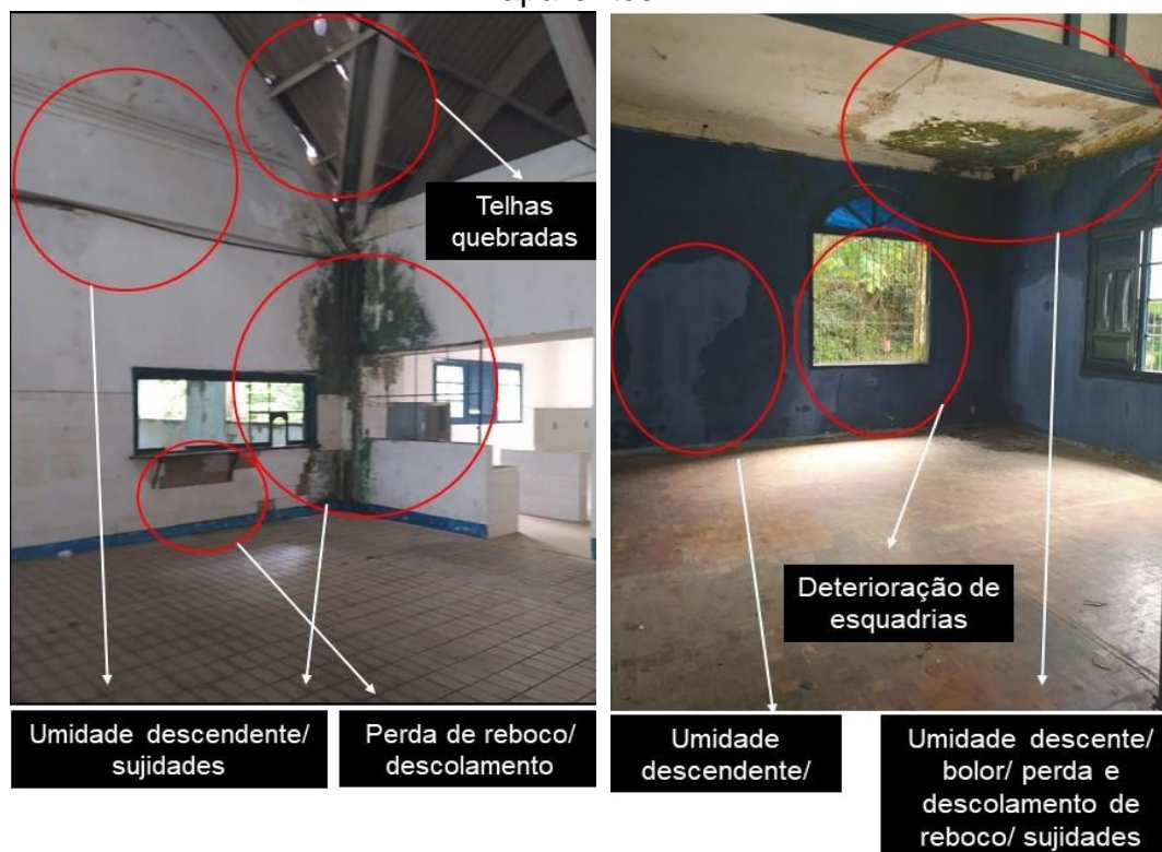
Figura 56: Fotografias do interior da antiga fábrica com indicação de suas patologias aparentes.
