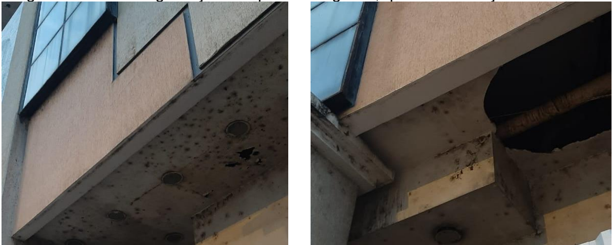
Figuras 78 e 79: Degradação das placas de gesso, que faz a forração da fachada
