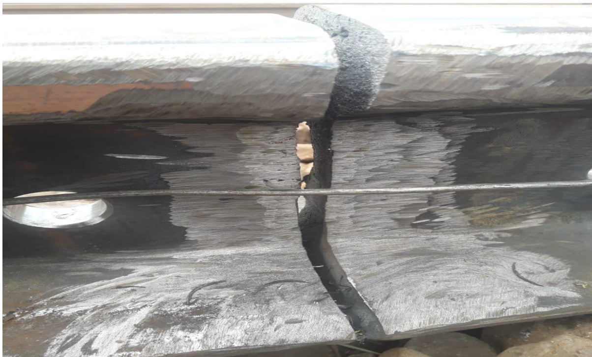
Figura 02: Fratura em Solda elétrica
