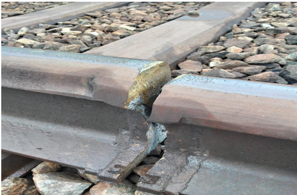
Figura 03: Fratura em Solda aluminotérmica Fonte: Autores (2020)
