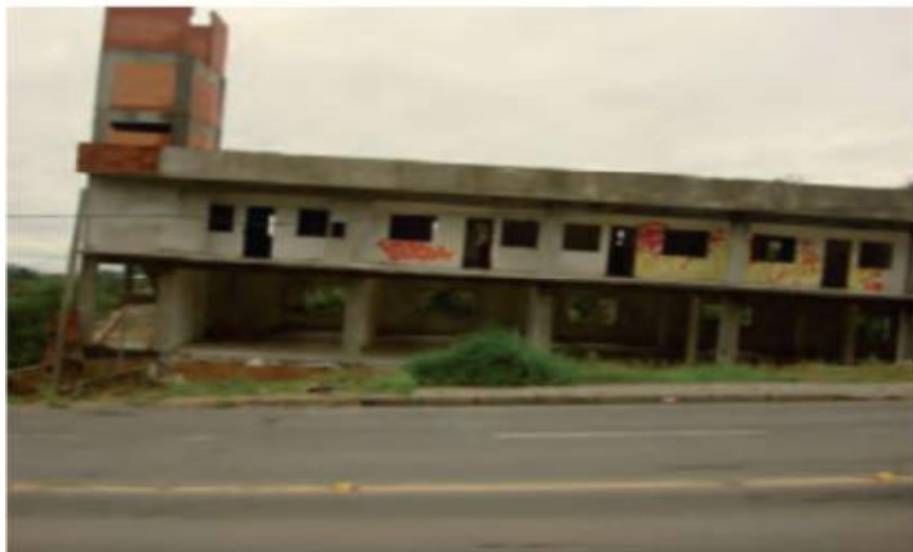
Figura 3: Recalque diferencial proveniente do deslocamento pluvial.
