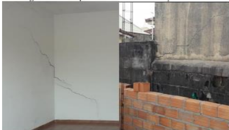
Figura 4: Agravamento de fissuras causadas por recalque diferencial
