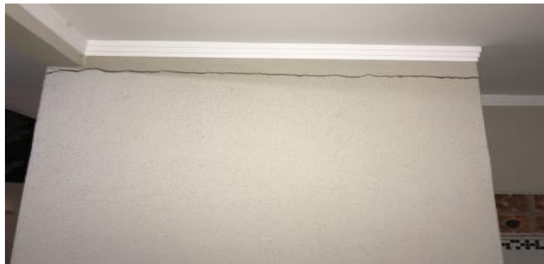
Figura 5: Fissuras ocasionadas pelo adensamento do solo
