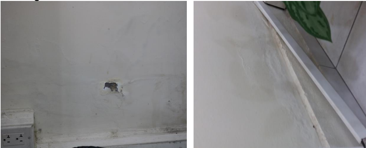
Figura 9 - Eflorescências encontradas no Prédio da CEMIG
