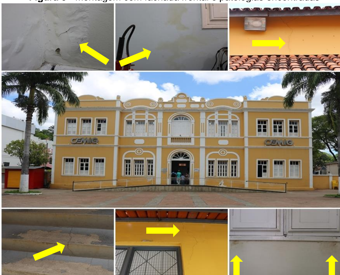
Figura 5 - Montagem com fachada frontal e patologias encontradas
