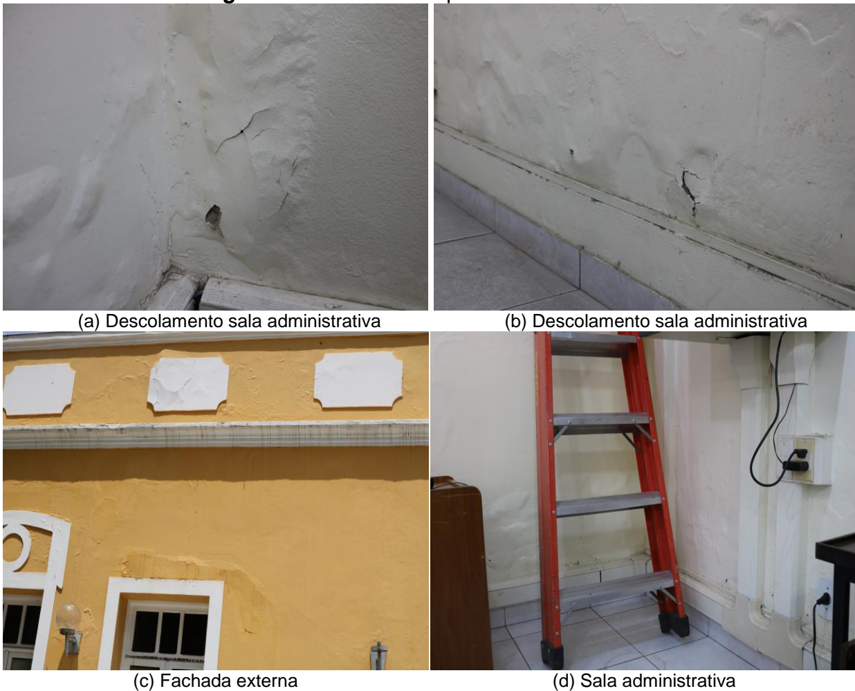
Figura 12 - Bolhas e Empolamento de revestimentos
