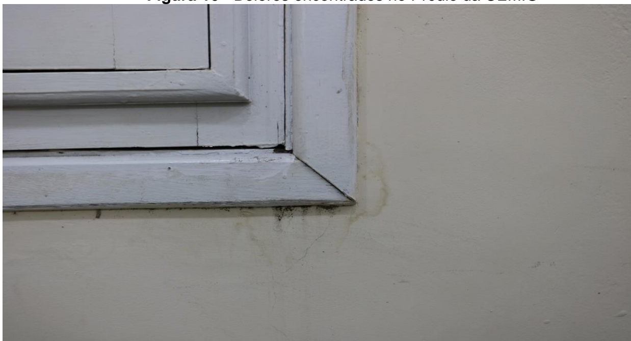
(a) Bolor abaixo da janela na sala administrativa
