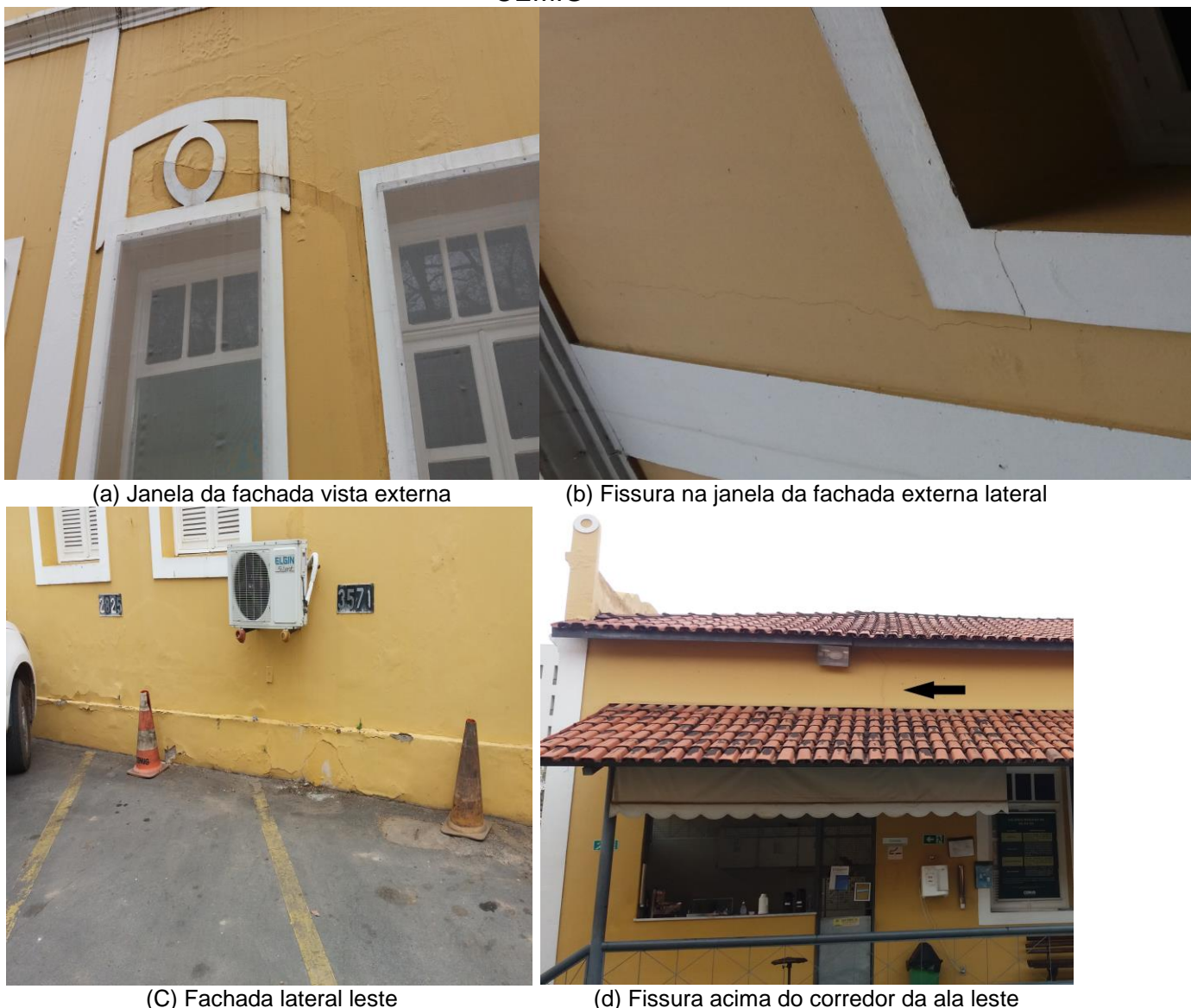
Figura 8 - Fissuras encontradas (parte interna e externa) no Prédio da CEMIG
