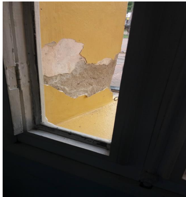
(b) Descolamento cima do peitoril na janela frontal do prédio
