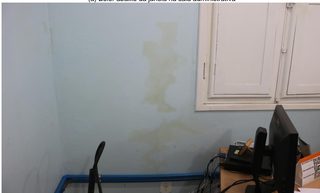
(b) Bolor localizado na sala de atendimento
