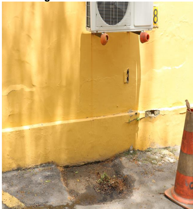
(a) Descolamento parte externa
