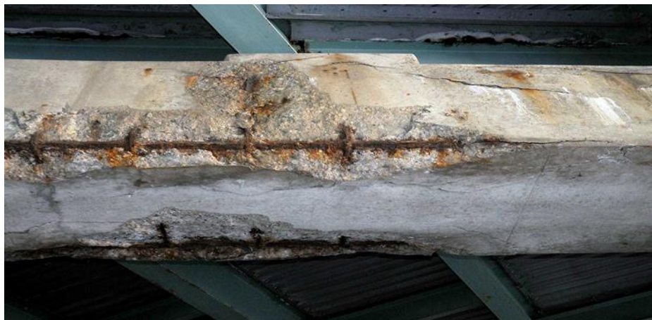
Figura 3- Estrutura de concreto com reações corrosivas (Souza,2002)
