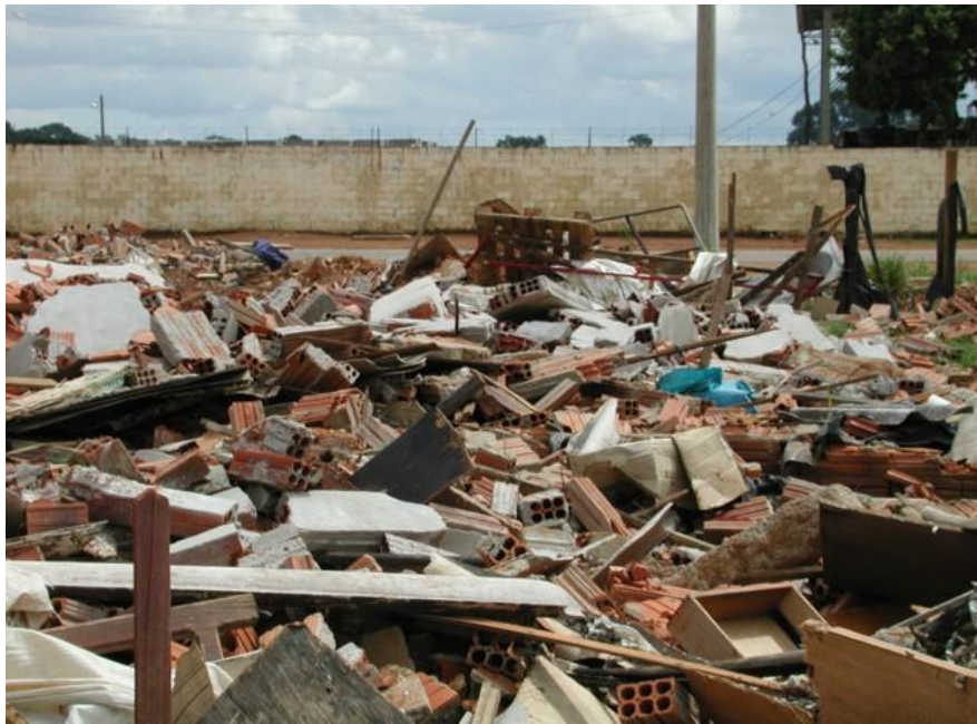
Figura 10: Resíduos de construções lançados em local inadequado
